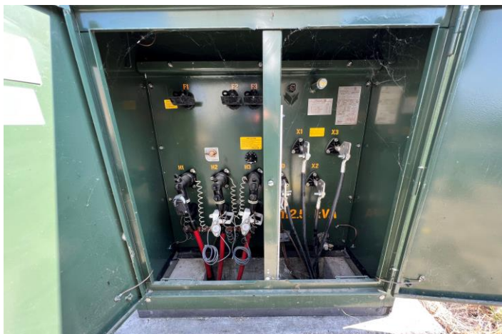
Figura 19 Transformador trifásico tipo pedestal capacidad 112.5kVA 13800 / 220-127 V
