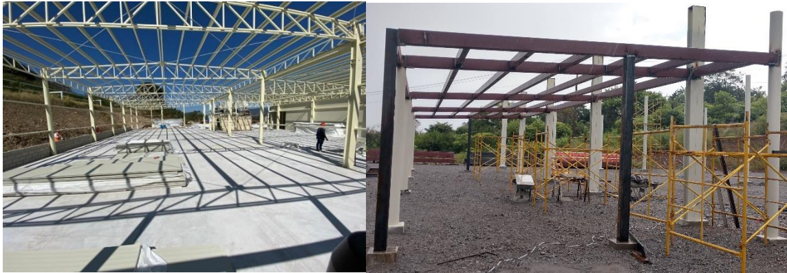
Figura 33 a) Acero estructural de planta DGA DE NAYARIT que se emplearán como bajantes naturales, b) Detalle de soldadura en estructuras para un mejor acoplamiento eléctrico
