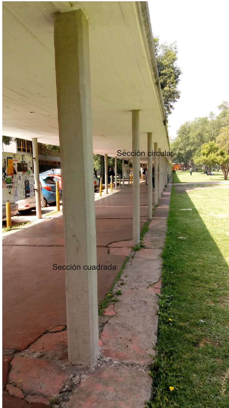
Figura 8.- Sobre el pasillo que conecta a la unidad multidisciplinaria de la Facultad de Arquitectura con el edificio principal de la Facultad de Arquitectura, se puede observar en primer plano que varias columnas han sido modificadas de una sección circular a una cuadrada.
