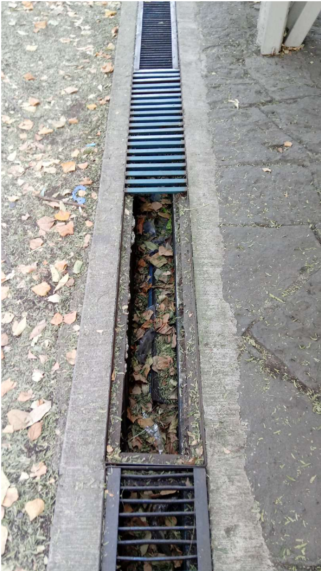
Figura 44. Estado actual de los drenes. Se observa falta de rejillas, azolve y ductos de instalaciones canalizados a través de los drenes.
