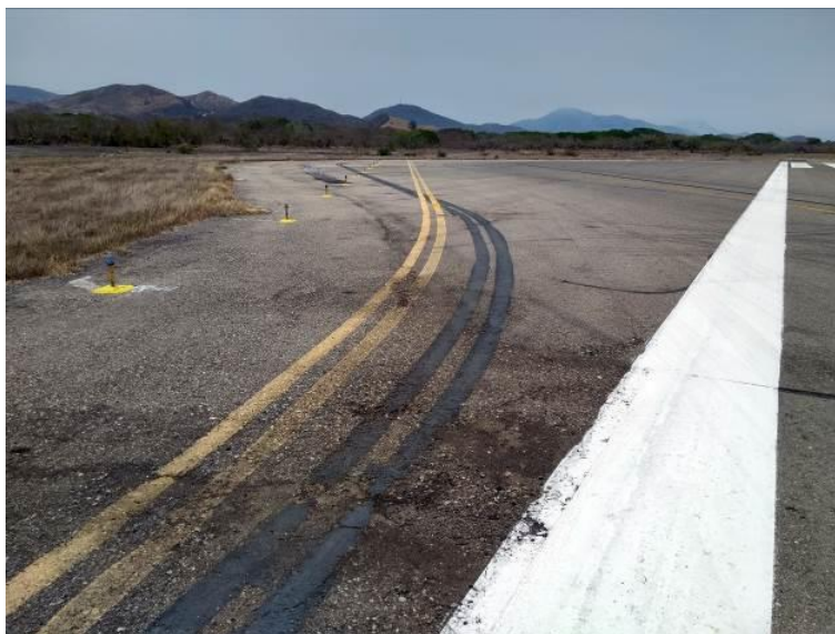
Figura 23. Inspección visual de superficie de Plataforma de Viraje 26.
