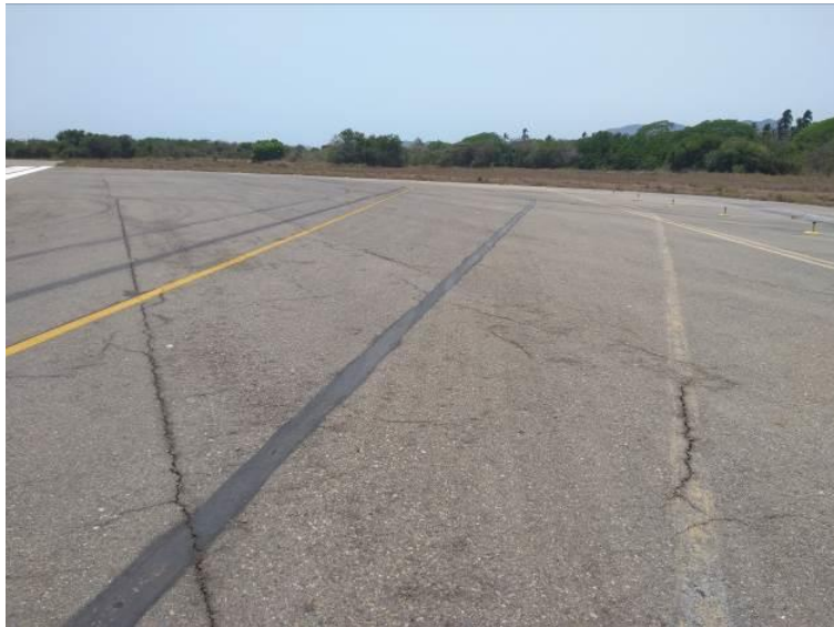
Figura 22. Inspección visual de superficie de Plataforma de Viraje 08.
