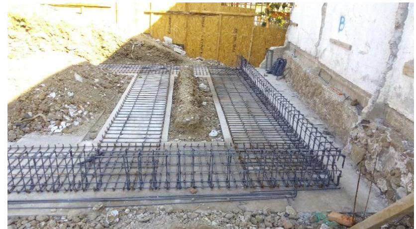
Habilitado y armado de acero de refuerzo de refuerzo en zapata y contratabe.
