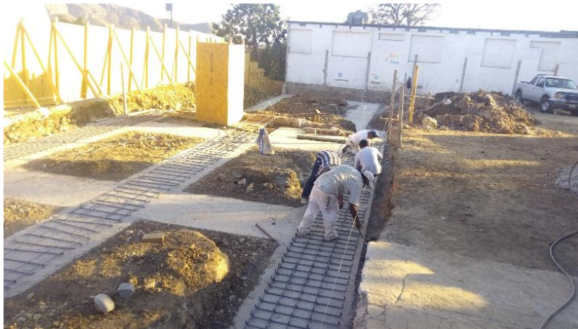
Habilitado de acero de refuerzo para en cimentación siguiendo las indicaciones del proyecto.
