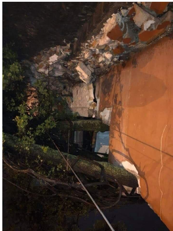
Barda dañada. Foto: Twitter San Miguel Allende de blanco
