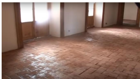
Fig. 12. Colocación de piso nuevo. Imagen tomada del video "Restauración del Museo Casa de Allende, 2009" del canal de youtube INAH TV
