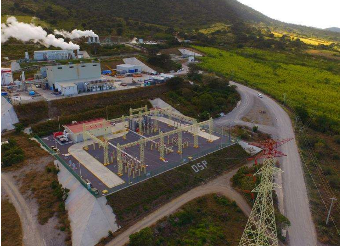
Figura 7 Vista de la planta geotérmica Domo de San Pedro
