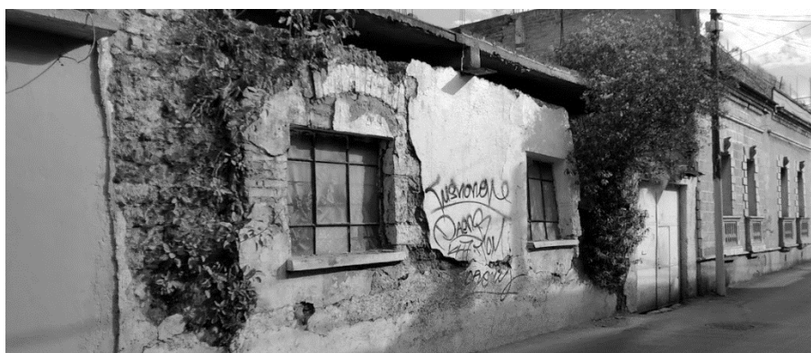
Figura 47 Inmueble 11 "colapso". (Fotografía de E. Itzamntul Flores Torres.)
