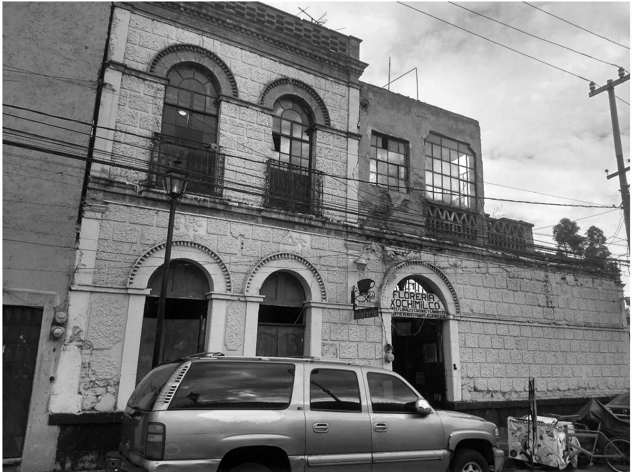
Figura 1 Estado actual de un inmueble catalogado por el INAH al cual se le han hecho intervenciones que no consideran el lenguaje arquitectónico existente. (Fotografía tomada por E. Itzamntul Flores Torres.)
