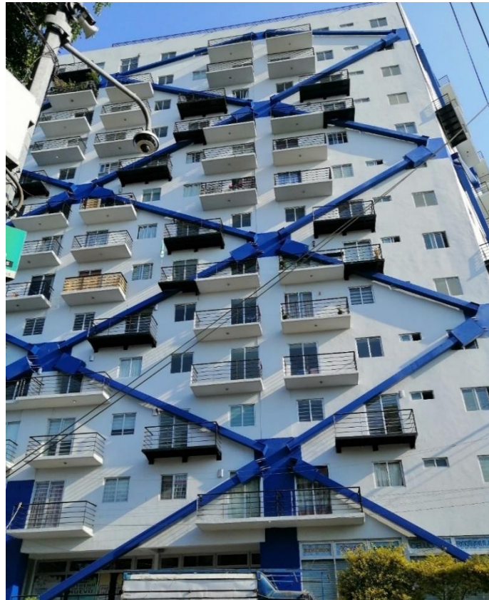
Figura 3.13. Fotografía del edificio rehabilitado con los disipadores.
