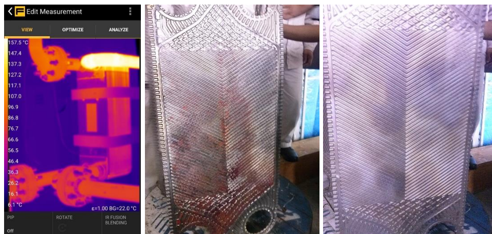
Fig. 15 Termografía del HPE y placa tipo chevron después de entrar en contacto con el agua geotérmica y después de un proceso de limpieza
