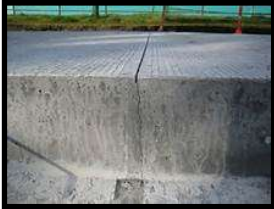
Fig. 33.- Corte Inicial Transversal y Grieta Inducida.
