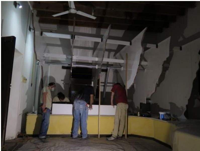
Detalle de la colocación del sistema estructural. Fotografía: S. Cruz, PNCPGR, CNCPC-INAH, 2018.
