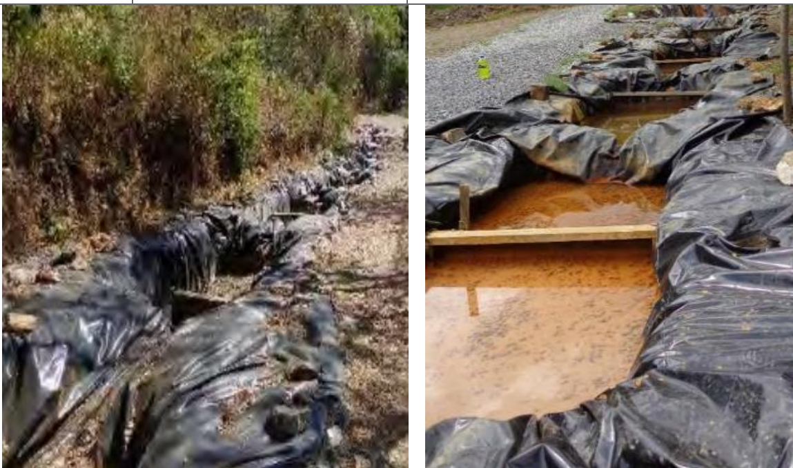
Figura A1.1 Sistema de remediación con filtros de roca caliza y sedimentadores (PP1) in situ.
