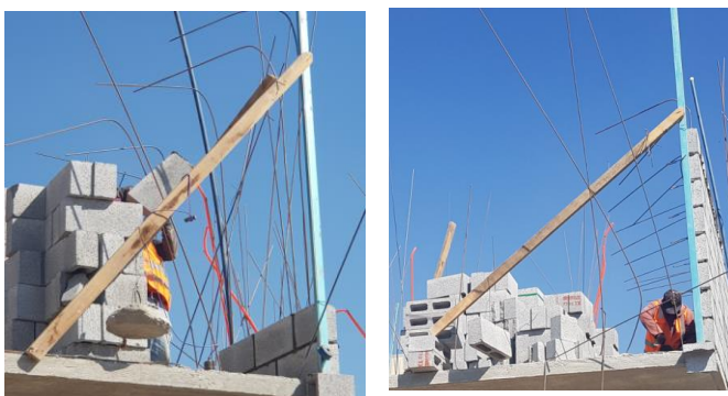
Ilustración 41 Ejemplo de reglas mal colocadas. Fuente del autor
