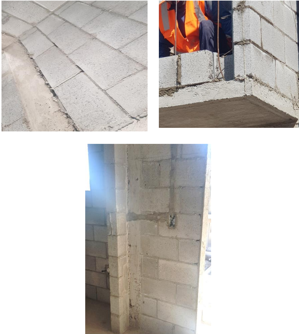
Ilustración 44. Ejemplo de muro sin junteo correcto. Fuente del autor
