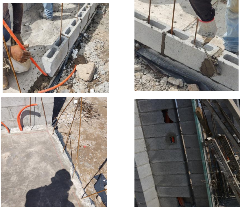
Ilustración 38. Problemas en primera hilada. Fuente del autor
