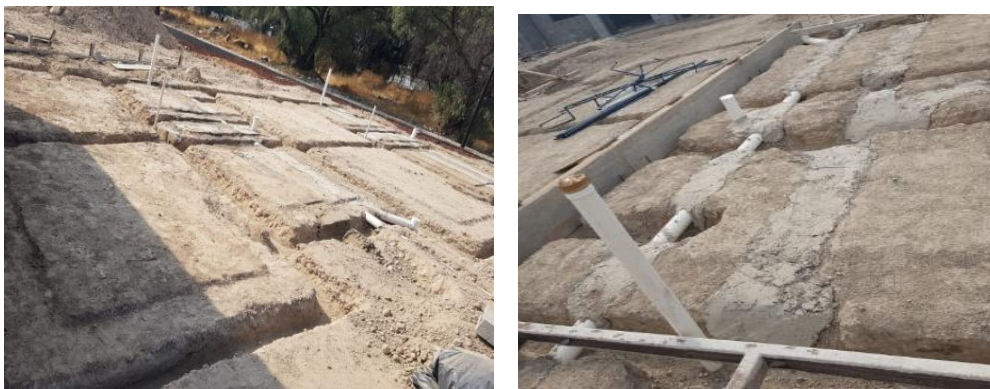
Ilustración 20.- Ejemplo de instalaciones hidráulicas y sanitarias. Fuente de autor
