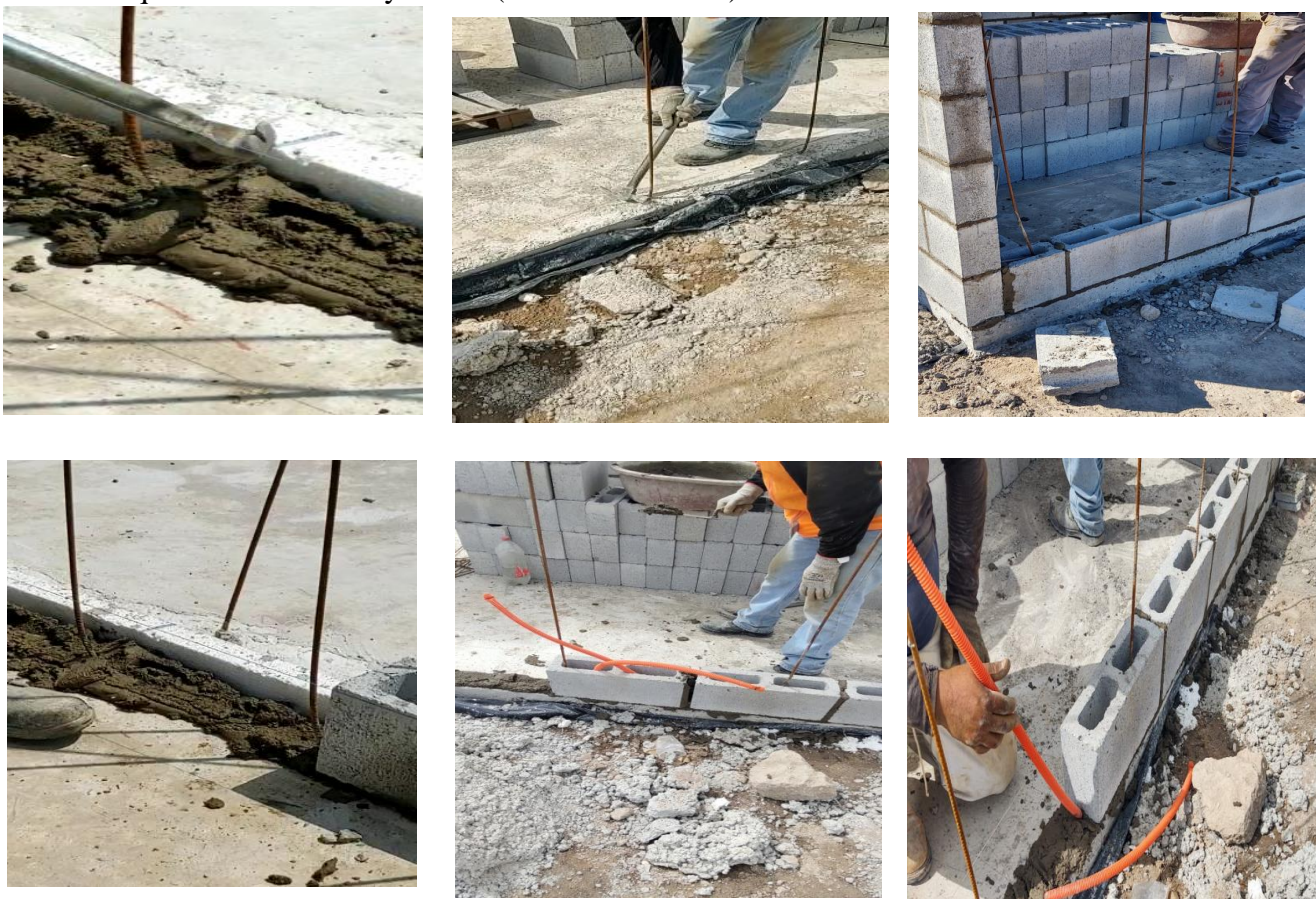
Ilustración 37. Ejemplos de problemas en la cimentación. Fuente del autor
