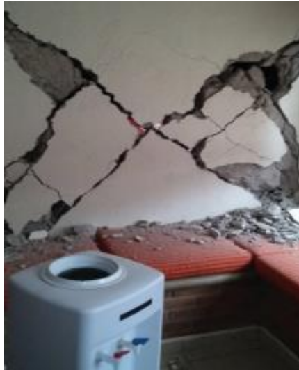
Figura IV.28. HGRMF No. 7 de Cautla, Morelos (Fuerza México, 2022)
