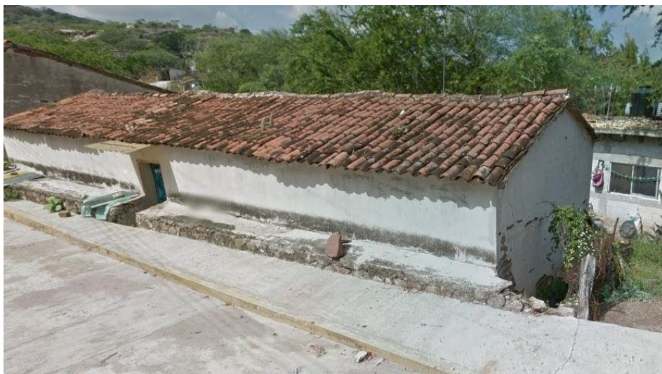
a) Antes del sismo, modificada de Google Earth, (2017)
