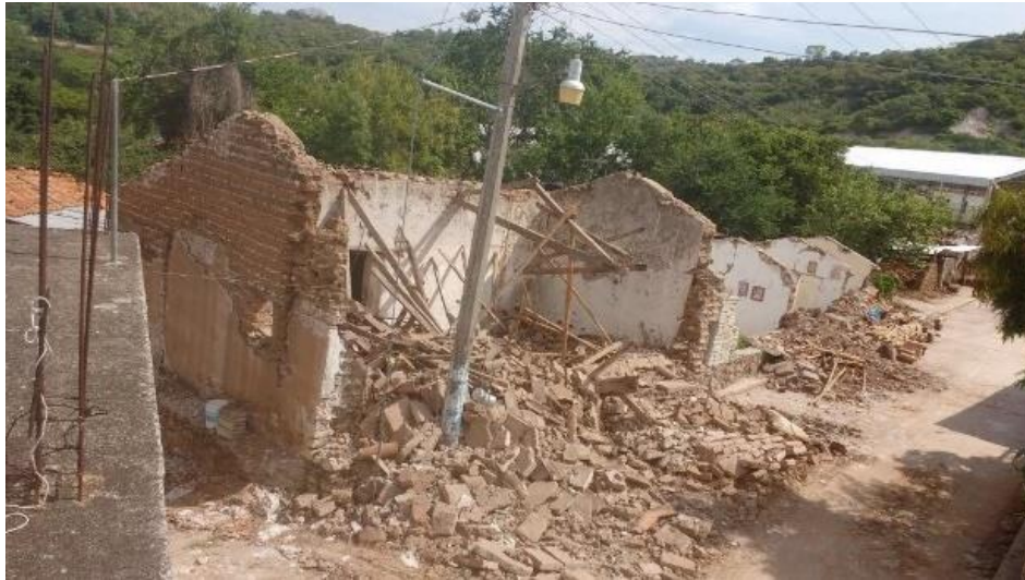
b) Después del sismo, modificada de ERN, (2017) Figura IV.30. Casa habitación en Cohetzala, Puebla
