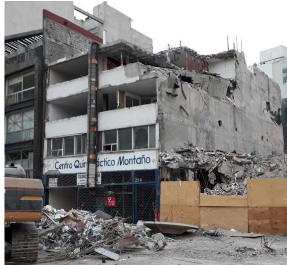
b) Después del sismo, modificada de (Sobse, 2018)
