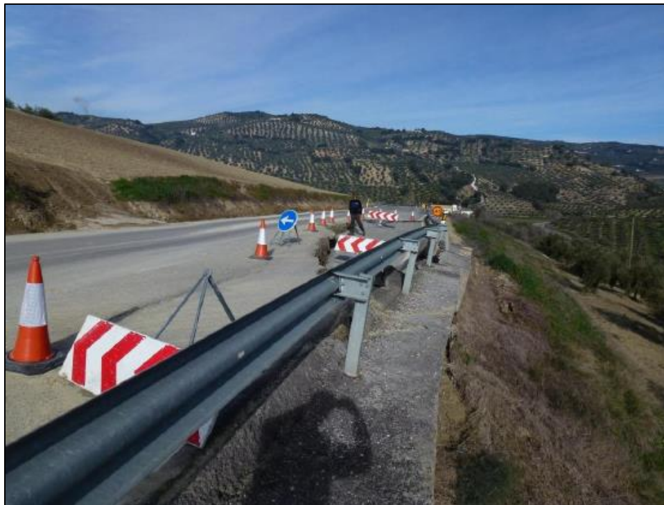
Figura 2.14. Deslizamiento de una carretera (Ramajo et al., 2014).
