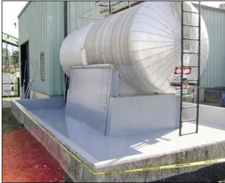
Figura 2.15. Cubeto de retención protegido con un revestimiento belzona (Marco, 2012).
