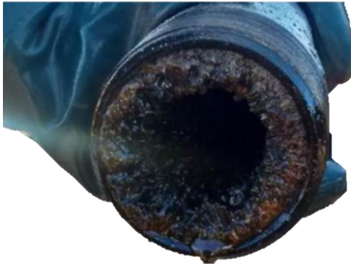
Figura 9. Crecimiento radial de incrustaciones en tubería de producción con impregnación de hidrocarburos y oclusión aproximada del 50% (Lajoine et al., 2020).
