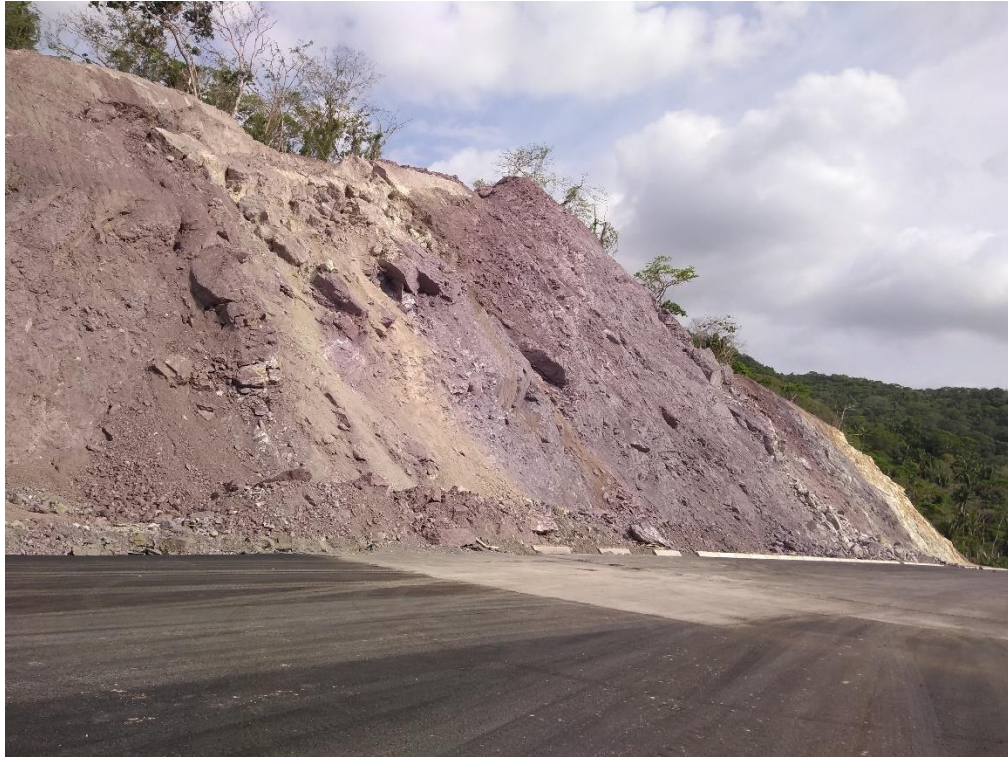
Ilustración 35 Caído 71+100 al km 71+340 II. Tomado de reporte Fotográfico SCT 03 de julio, 2018.
