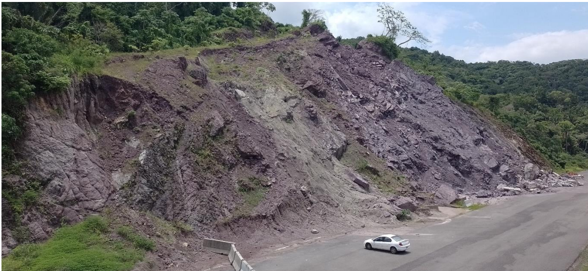
Ilustración 48 Vista del talud de corte 13 de agosto de 2022.
