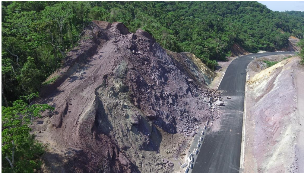
Ilustración 37 Caído 71+100 al km 71+340. Tomado de reporte Fotográfico 03 de agosto SCT, 2018.
