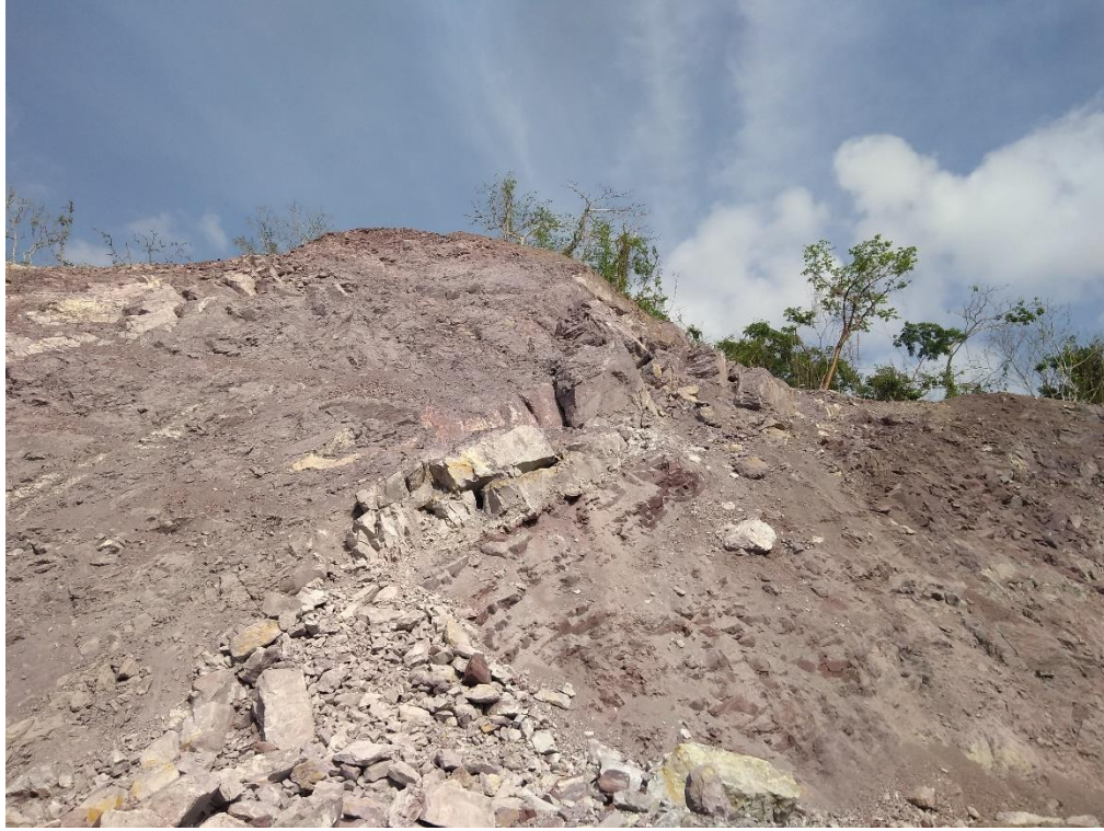
Ilustración 34 Caído 71+100 al km 71+340 I. Tomado de reporte Fotográfico SCT 03 de julio, 2018.
