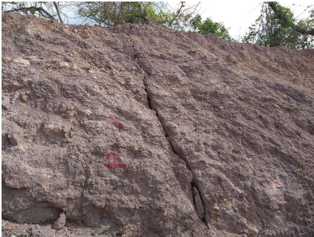
Ilustración 36 Grieta en camino de pobladores I. Tomada de reporte Fotográfico SCT 03 de julio, 2018.
