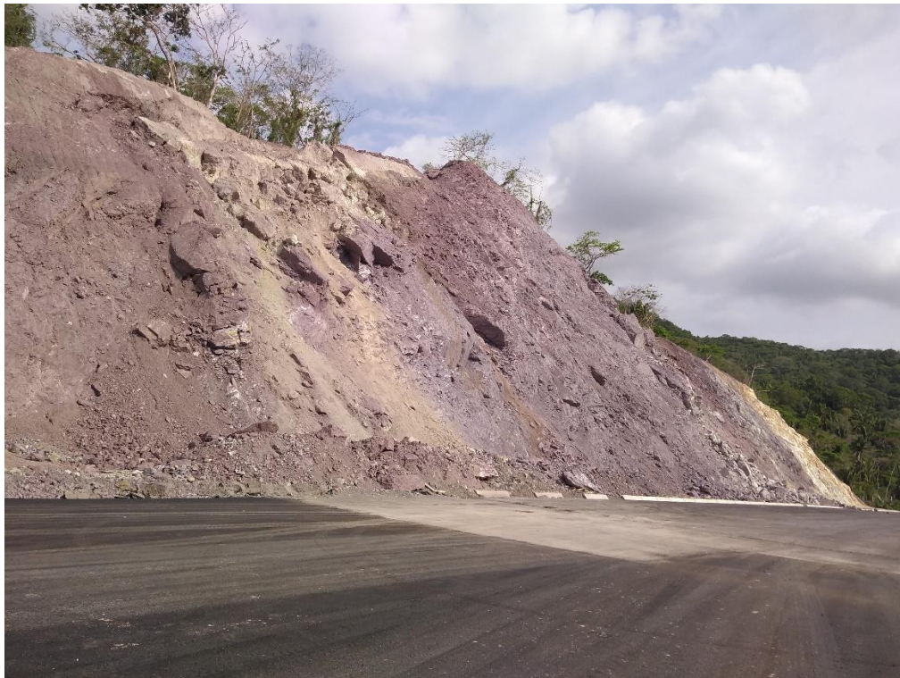
Ilustración 33 Caído 71+100 al km 71+340 II. Tomado de reporte Fotográfico SCT 03 de julio, 2018.
