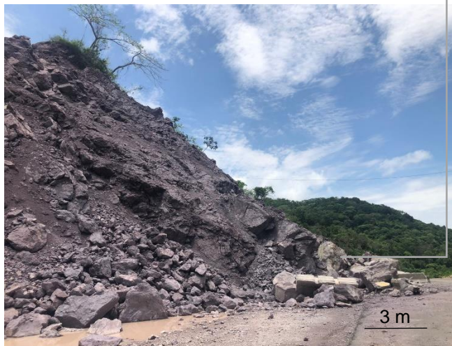
Ilustración 43 Vista del talud de corte 16 de julio de 2022.
