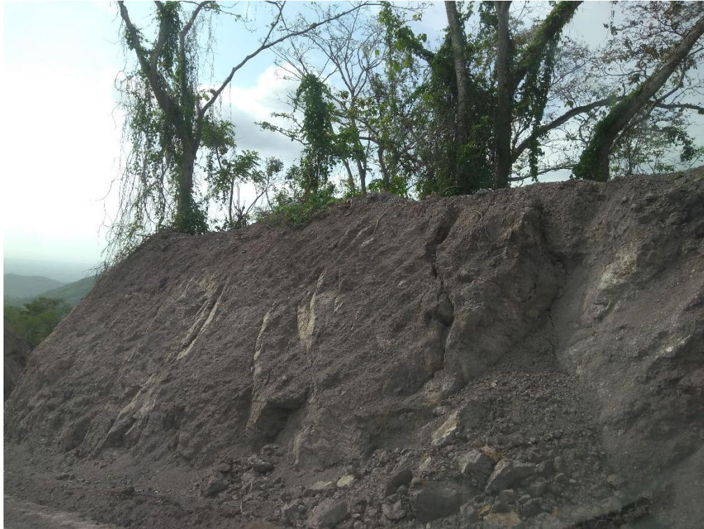
Ilustración 38 Grieta en camino de pobladores II. Tomada de reporte Fotográfico SCT 03 de julio, 2018.
