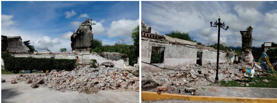
Ilustraciones 179 y 180: Fotografías de los restos colapsados de los vestigios de la casa grande. Fuente: Tomadas por Fernando Javier Flores Nájera el sábado 23 de septiembre de 2017
