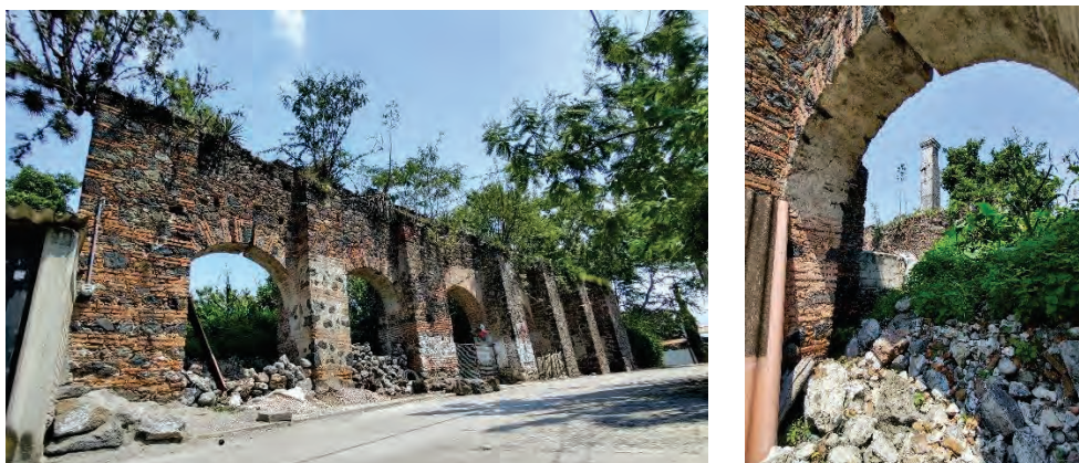
Ilustraciones 197 y 198. Fotografías del trapiche con los restos colapsados del 2017 aun acumulados en 2022. Fuente: Tomadas por Fernando Javier Flores Nájera el 2 octubre de 2022
