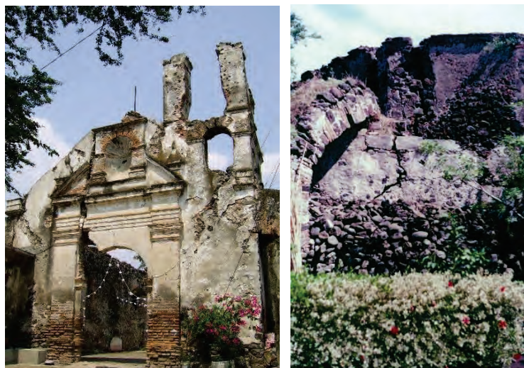
Ilustraciones 113 y 114: Fotografías del estado que guardaba las fachadas frontal y posterior de la capilla al inicio de la investigación en el año 2006, en la portada se apreciaban impactos de arma de fuego, como testigos de la lucha revolucionaria de 1910. Fuente: Tomadas por Fernando Javier Flores Nájera en el año 2006
