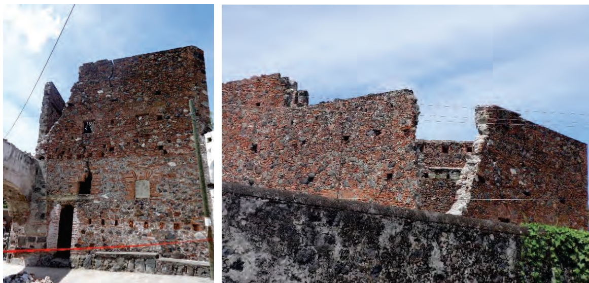
Ilustraciones 181 y 182: Fotografías de los daños ocasionados en “El Castillito” posterior a los sismos del 7 y 19 de septiembre de 2017 Fuente: Tomadas por el Fernando Javier Flores NÁJARA el sábado 23 de septiembre de 2017
