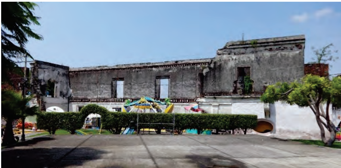
Ilustraciones 148 y 149: Fotografía del año 2006, y el estado en que se encontraba la fachada de los almacenes, y fotografía de las obras concluida de restauración de la misma, ejecutada a partir del año 2010. Fuente: Tomadas por Fernando Javier Flores Nájera.
