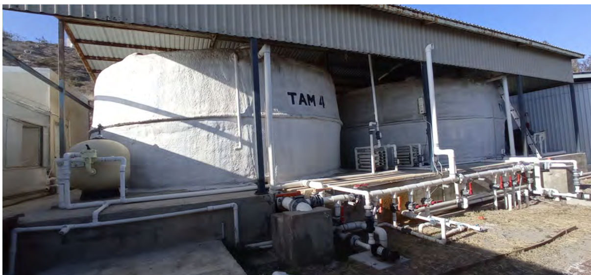
Figura 5.25: Zona de acondicionamiento de agua marina.
