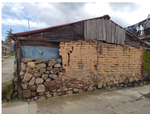
Figura 6. Ejemplo de una vivienda rural con problemas en cuanto a precariedad habitacional en Cherán Atzicurin, Michoacán. Fuente: elaboración propia.
