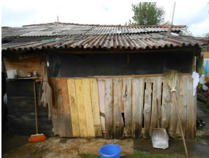
Figura 9. Cocina con techo de lámina de asbesto y lámina de cartón.
