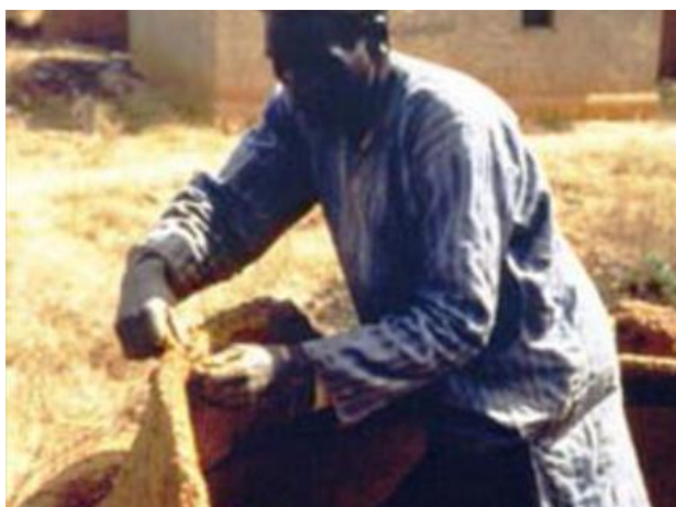
Figura 3 (superior): Construcción de vivienda con ladrillos sin secado previo.
