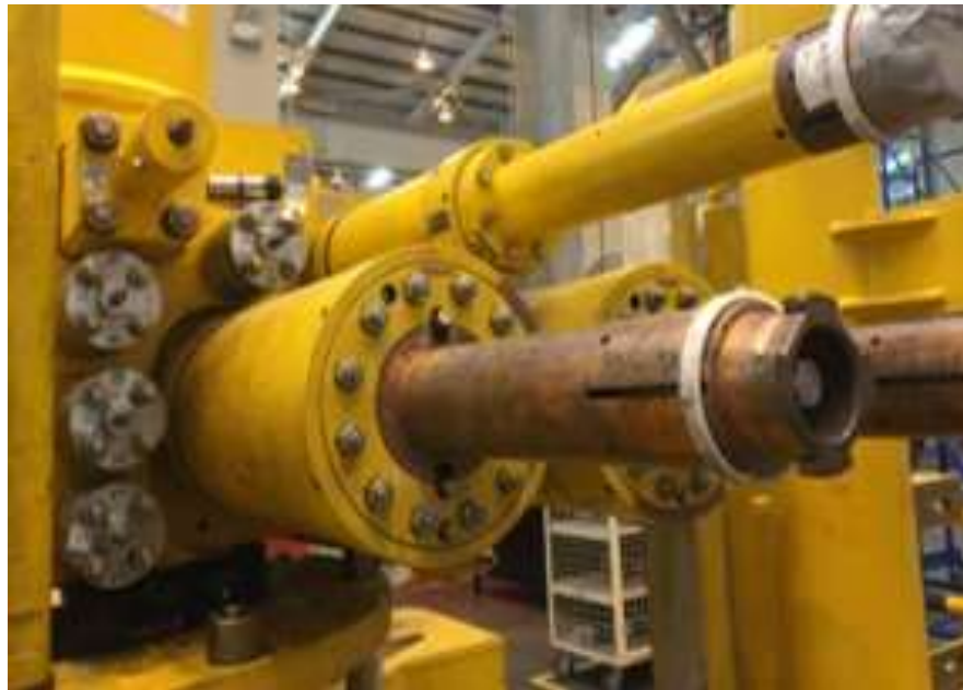
Figura 4.12 Armado del Bloque de Producción con las válvulas XO y la PWV 57
