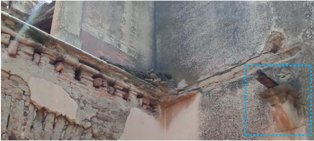
Ilustración 133 Riel que sirvió de apoyo para sostener una de las terrazas de las habitaciones en planta alta. | Elaboración propia. 2022.
