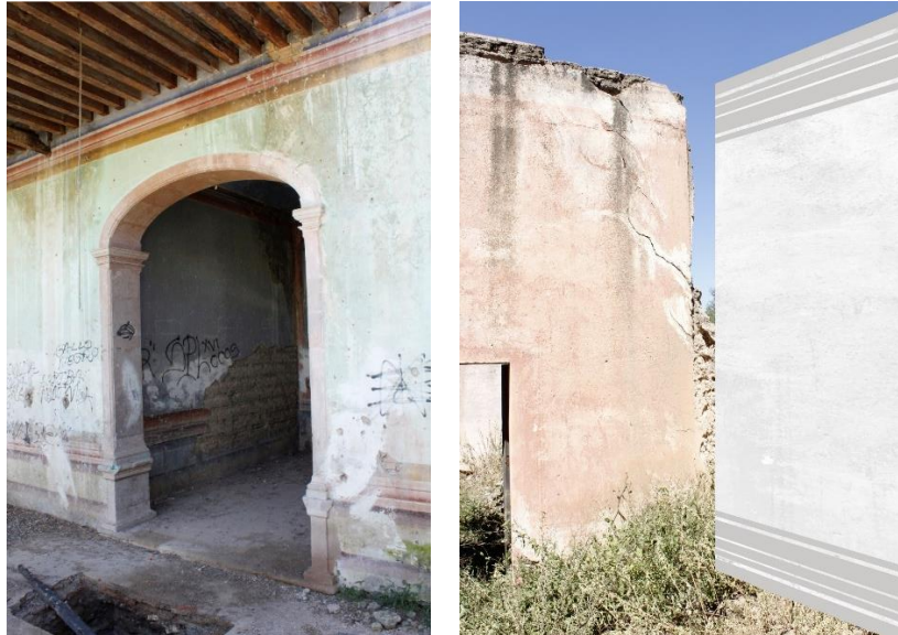
Ilustración 224 A la izquierda, pintura mural original. A la derecha, propuesta de reintegración en muros.
