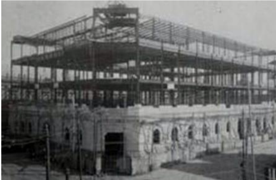
Ilustración 37 Estructura del edificio de Correos, Ciudad de México | Claudia Gámez. Revista Aventurero.
