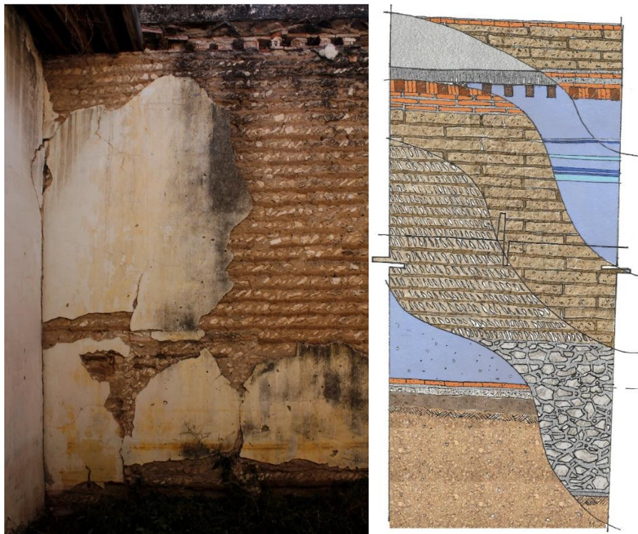
Ilustración 60 Fotografía y detalle de muro en el que se aprecia el rajueleado en la capa intermedia del muro. | Elaboración propia. 2020.
