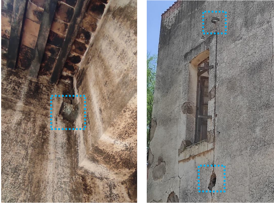
Ilustración 137 A la derecha, restos de ducto para extracción de humo. A la derecha, soportes metálicos sobre muro para ducto de extracción. | Elaboración propia. 2022.
