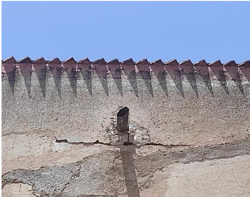
Ilustración 136 Desagüe pluvial metálico en la casa grande de la hacienda La Punta. | Elaboración propia. 2022.
