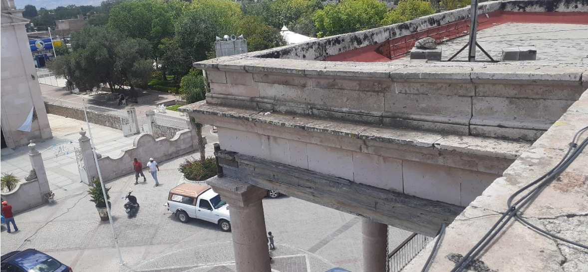
Ilustración 170 Cubiertas y entrepisos de la casa grande de Palo Alto. | Manual Técnico de Procedimientos de para la Rehabilitación de Monumentos Históricos en el Distrito Federal. (Croquis). Elaboración propia. 2022. (fotografías).
