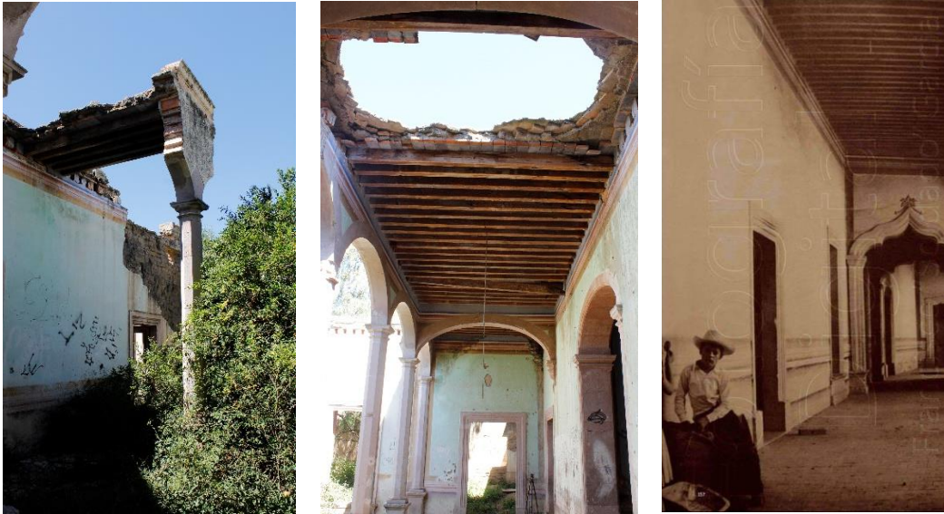
Ilustración 223 A la izquierda y al centro, daños en cubiertas de corredores en patio principal. A la derecha, fotografía tomada antes de 1940 donde se aprecia la cubierta original en perfecto estado.
