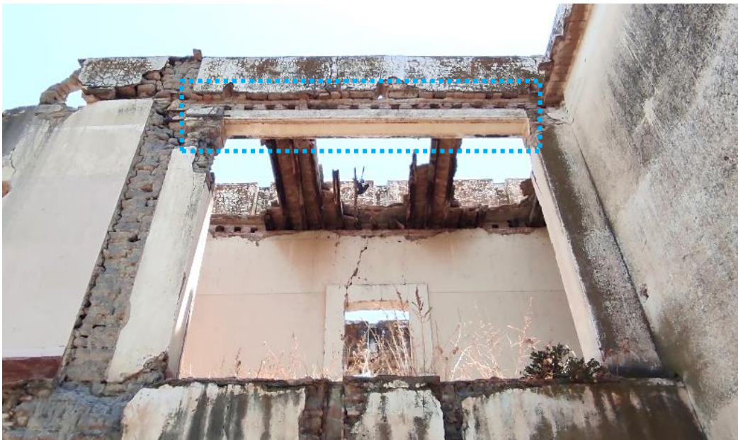
Ilustración 134 Trabe metálica que sostiene el claro donde se ubicaba la escalera en planta alta. | Elaboración propia. 2022.
