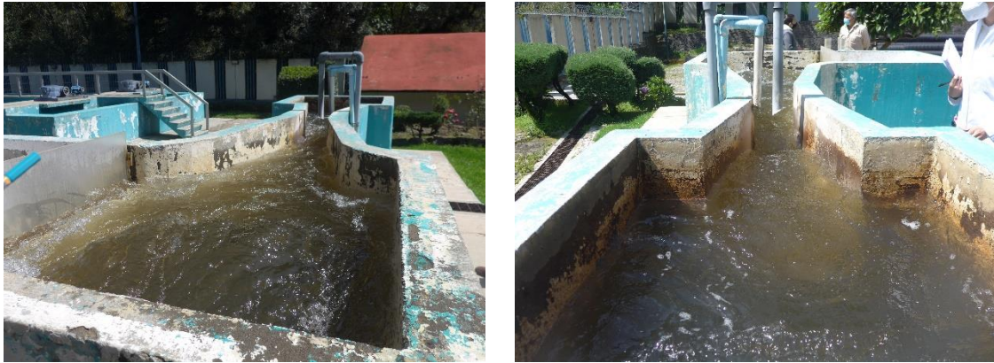
Figura 3.7 Canal Parshall, punto de dosificación de \text{NaClO} , \text{Ca(OH)}_2 y \text{Al}_2(\text{SO}_4)_3
