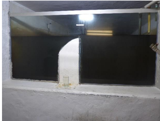
Figura 4.11 Vitrina del efluente de la planta; de lado derecho se ubica la salida de los filtros rápidos y el punto de dosificación de cloro cuando así se requiere, y de lado izquierdo el efluente de la planta.
