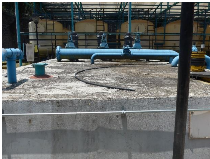
Figura 3.17 Cárcamo de agua cruda.
