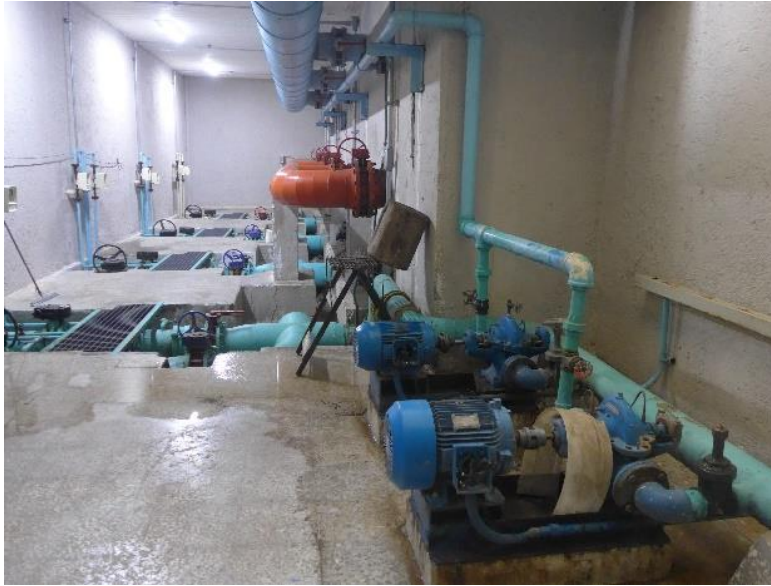
Figura 3.5 Fotografía del sistema de bombeo de la planta potabilizadora Río Magdalena (2021)
