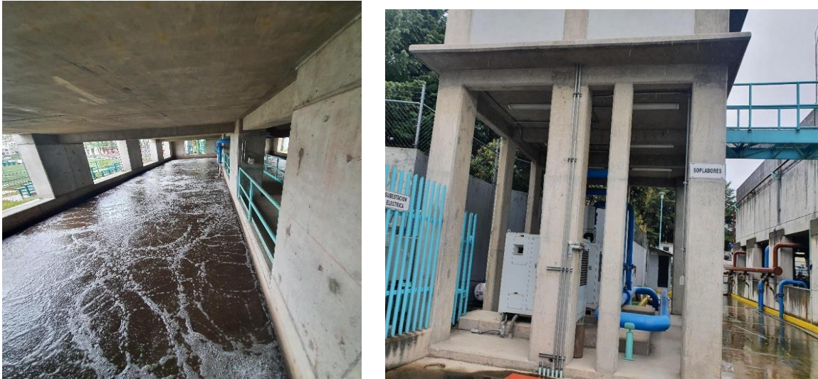
Figura 3.24 En la imagen de lado izquierdo se muestra el tanque de aeración, en la derecha el cobertizo en donde se encuentran los sopladores.
