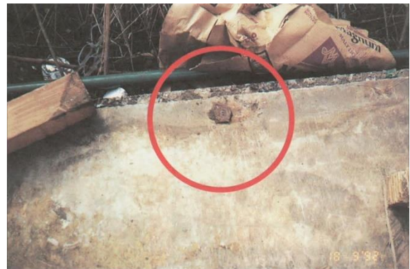
Figura 15 - Falla en la edificación en la cimentación y arrancamiento de anclajes
