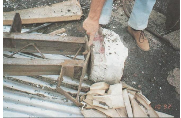
Figura 14 - Falla en la edificación debido a la edad y efectos de intemperismo, así como anclaje insuficiente para resistir fuerzas de levantamiento
