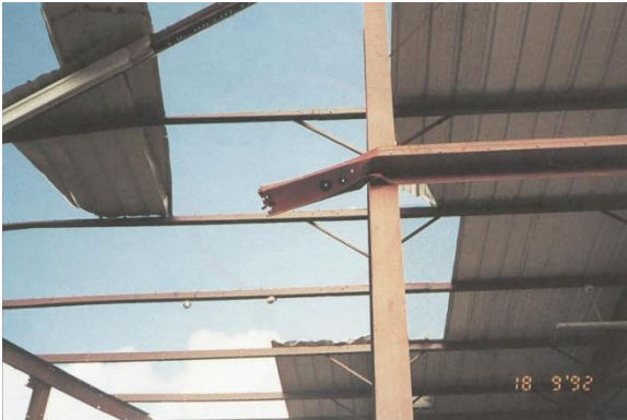
Figura 13 - Falla en la edificación debido al fallo de los miembros estructurales de cubierta (polines)
