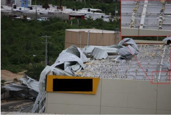
Figura 12 - Falla en la edificación industrial debido a la pérdida de cubierta ligera con lamina de bajo calibre
