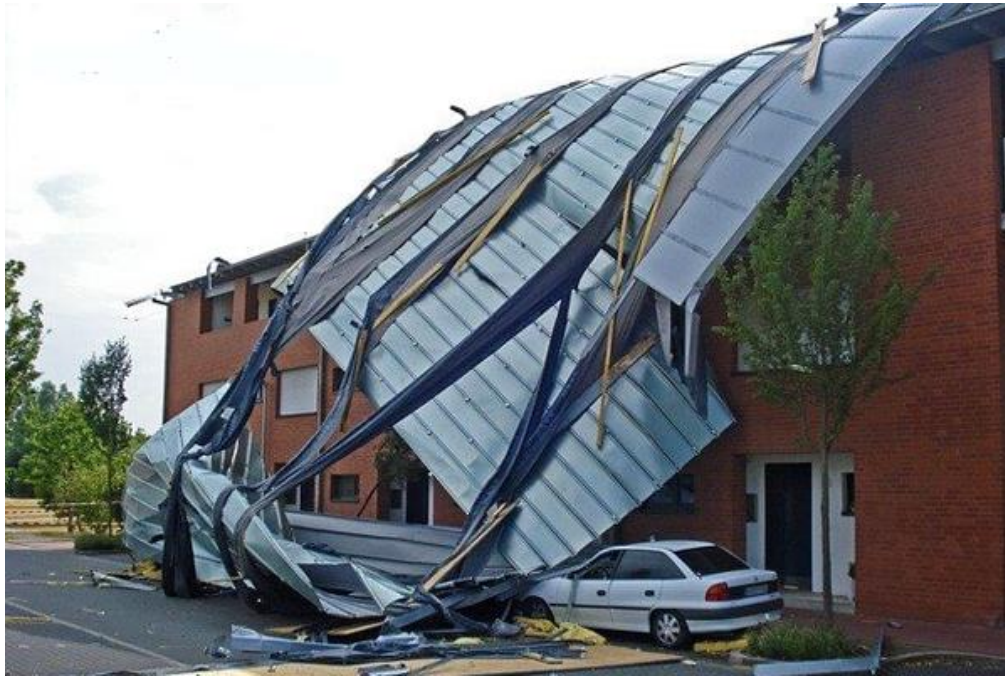
Figura 11 - Falla en Cubierta Metálica por carga de Succión
