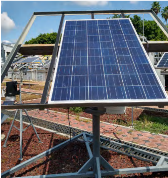
(a) MFV con la celda de referencia sobre una estructura de seguimiento solar de dos ejes.
