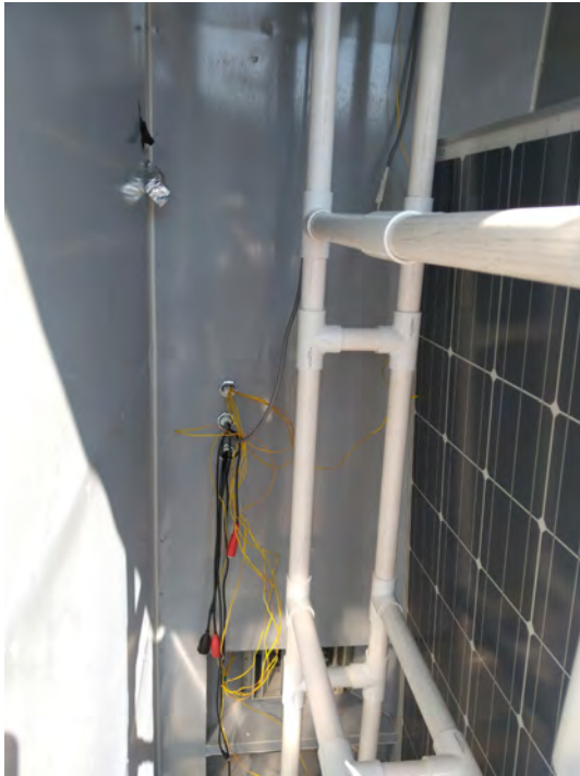
(a) Salidas de termopares, sensores de humedad y caímanes
