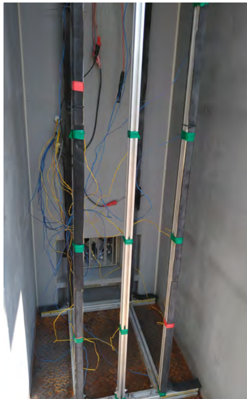
Figura 30: Estructura de PLP con termopares de caracterización de temperatura
