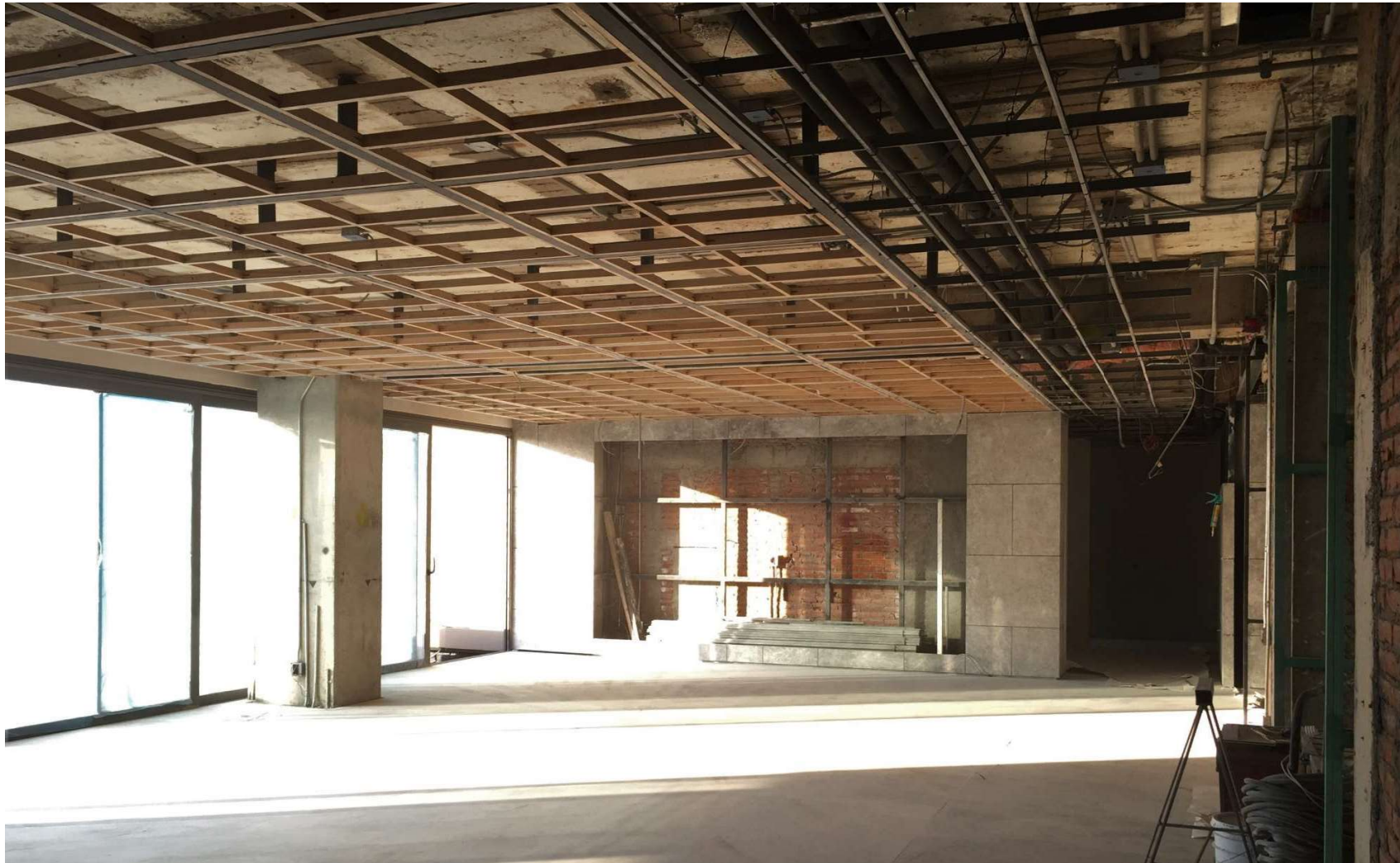
Figura 4.41. Proyecto P404. Vista sala comedor durante el proceso constructivo. Soportes de metal PTR 2" y de pino para recibir acabado de plafón de madera. Armado de canaletas para plafón de yeso. Colocación piso de mármol y muros de bastidores tubulares de zintro galvanizado para recibir mármol Tundra.
