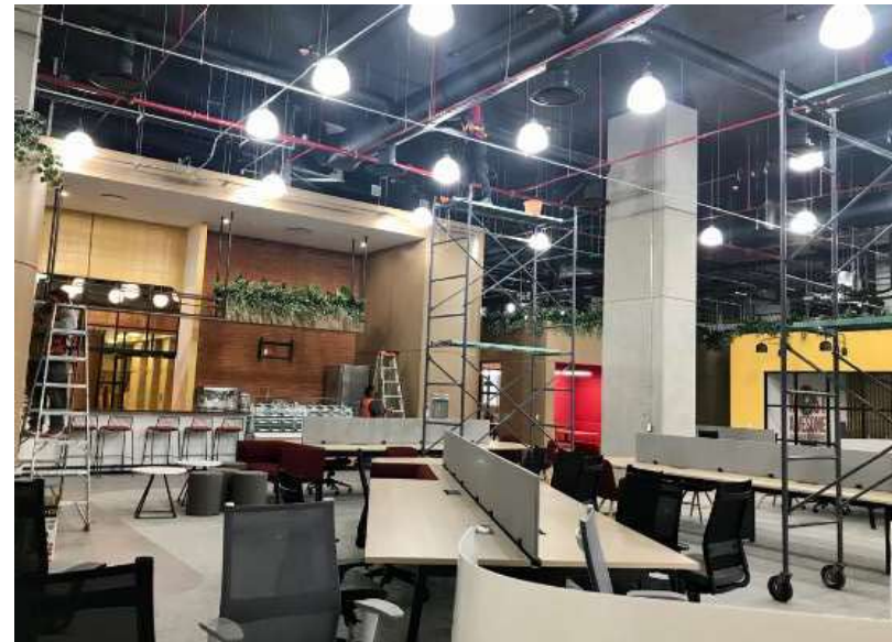
Figura 5.14 Trabajos durante la entrega sustancial, para concluir detalles en pintura de plafones.
