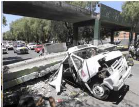
Figura 4.6 Colapso de puente peatonal debido al sismo de 2012 en Ciudad de México (Jaimes, 2012).
