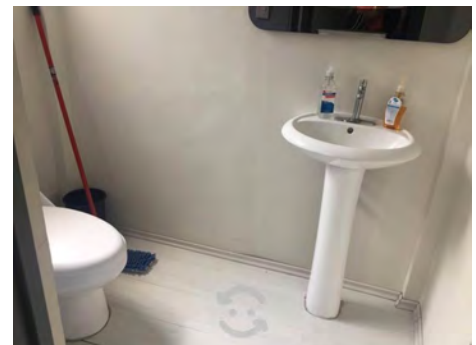
Fig. 52 Sanitario de consultorio
