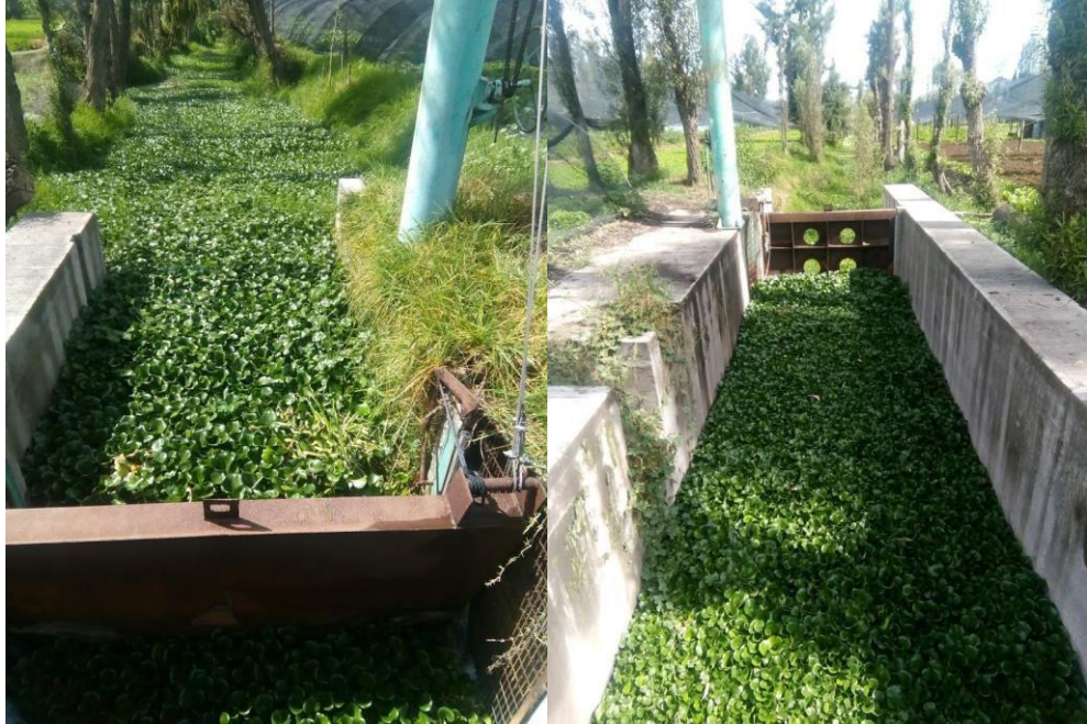
Compuerta en Desuso 1 (septiembre 18, 2019)
