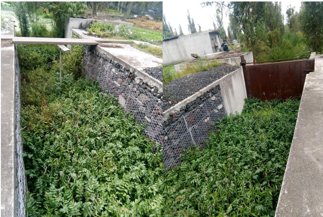
Compuerta en Desuso 2 (septiembre 18, 2019)
