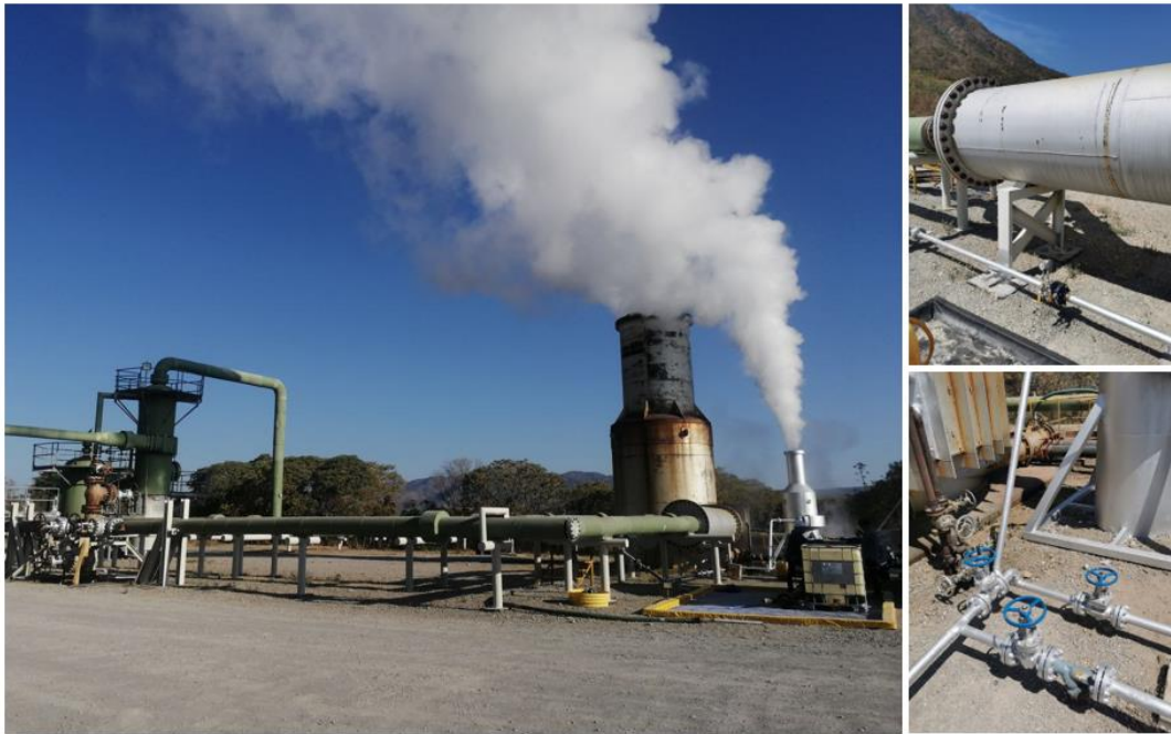
Figura 84. Conexión de las líneas de salmuera.
