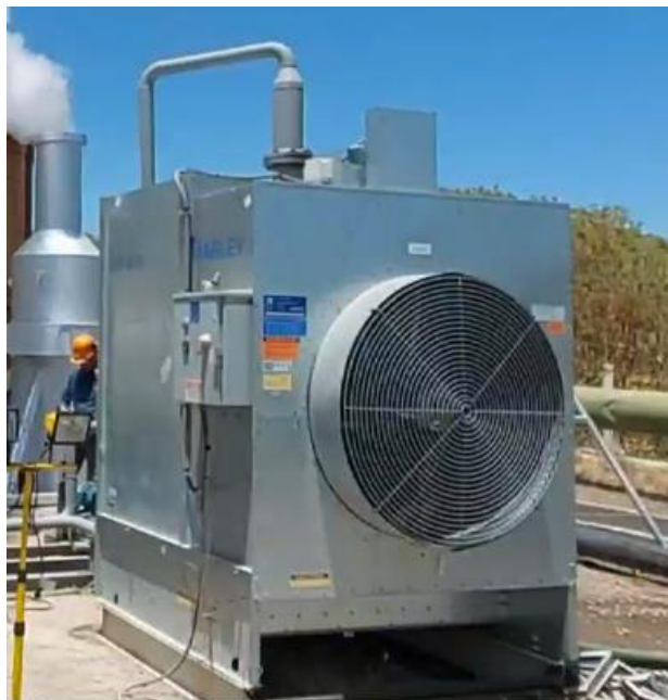
Figura 39. Torre de enfriamiento de tiro forzado.
