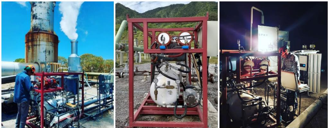
Figura 89. Ciclo IDEA 10 instalado
