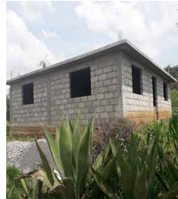
Chotejé, San F. del Progreso Techo concreto Muros de block Cimentación de mampostería
