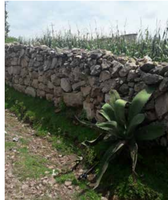
Chotejé, San F. del Progreso Barda de piedra sobrepuesta
