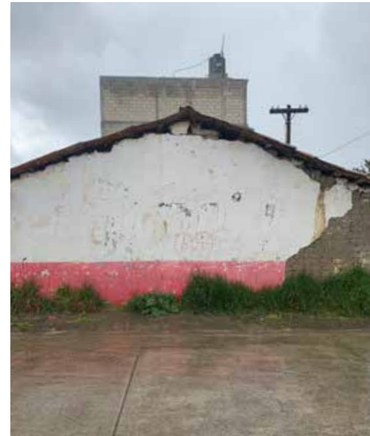
Fresno Nichi, San F. del Progreso Techo de teja de barro Muros de adobe Cimentación de mampostería
