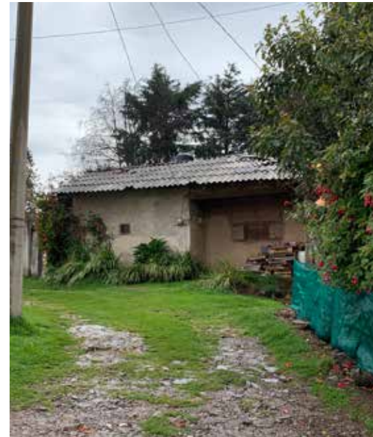
Fresno Nichi, San F. del Progreso Techo de lámina Muros de adobe Cimentación de mampostería
