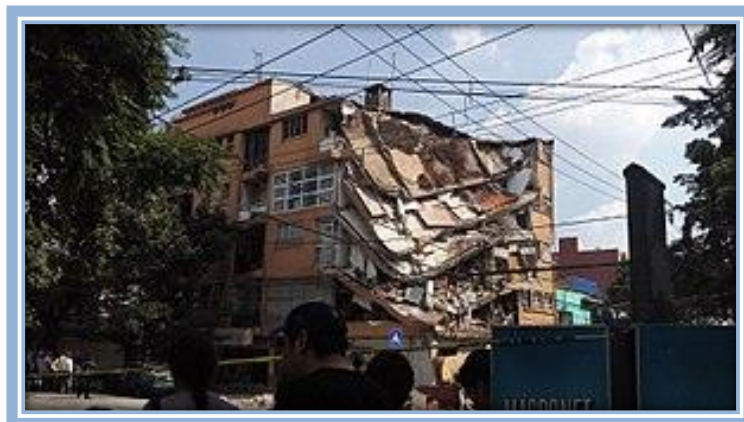
FIGURA 5 Edificio afectado por el terremoto en la delegación Benito Juárez, en la Ciudad de México Fuente: AntoFran, 2017
