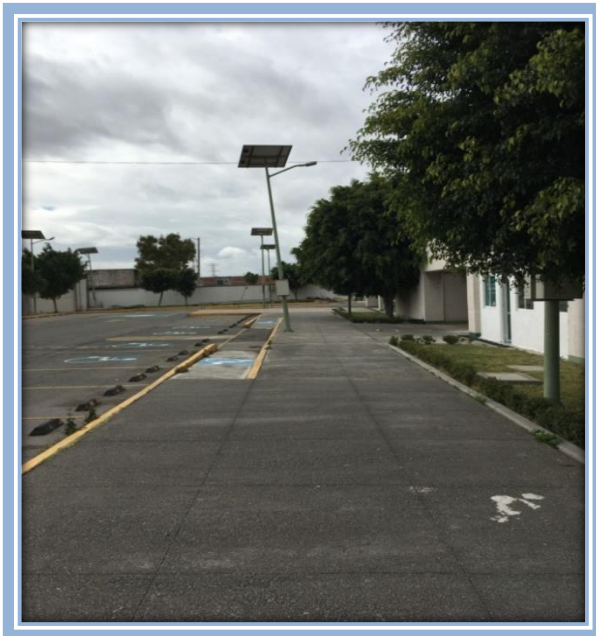
FIGURA 24 Ligeras asentamiento, estacionamiento principal
