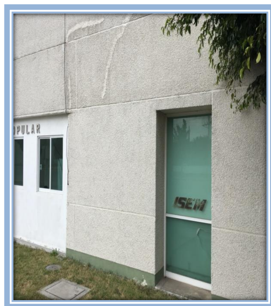
FIGURA 27 Fractura parte inferior del cristal por hundimiento, fachada principal
