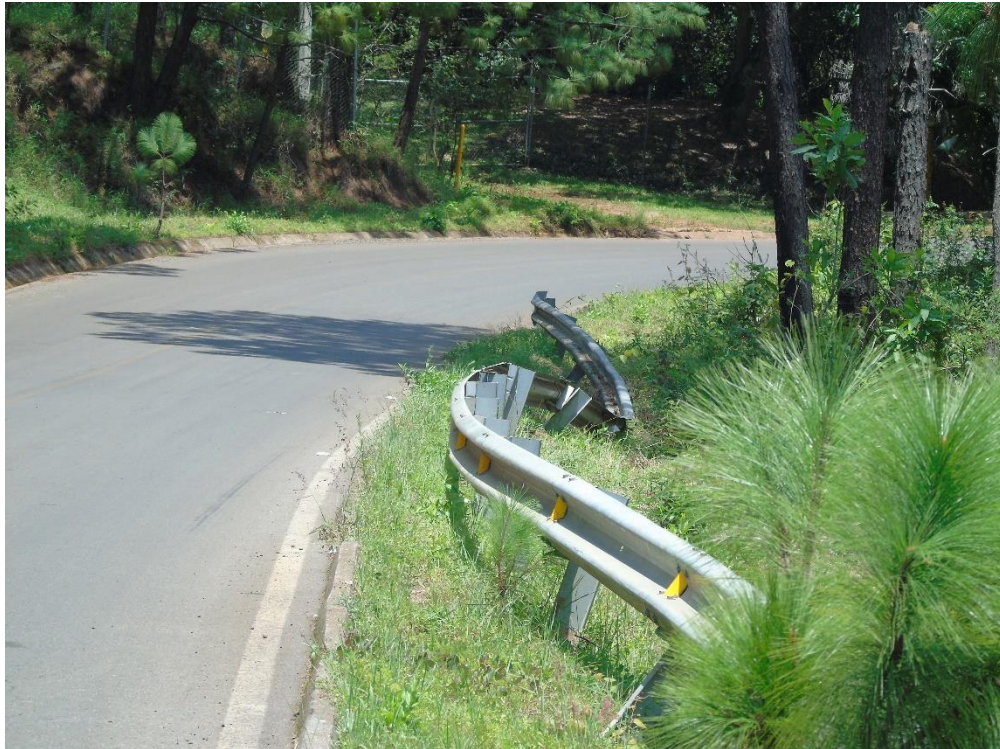
Figura 3.9.- Daños considerables en las barreras de seguridad.
