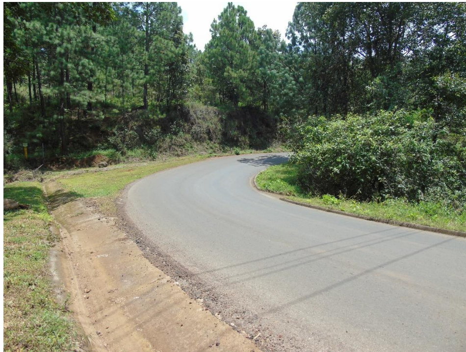
Figura 5.8.- Estado de la señalización de la carretera.
