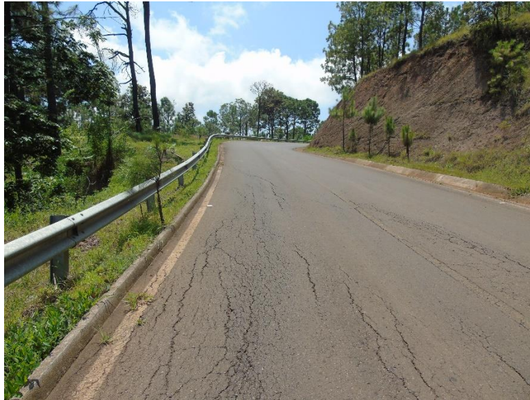
Figura 3.10.- Agrietamiento de tipo mapa en la carretera.
