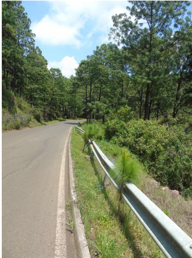
Figura 3.8.- Barreras de seguridad dañadas a causa de accidente.
