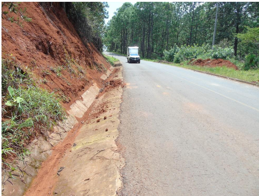
Figura 3.11.- Deslave en la carretera.
