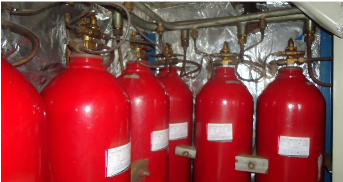
Ilustración 16. Rack de cilindros de supresión de incendio de CO 2
