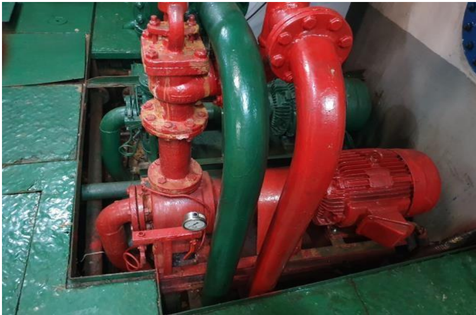
Ilustración 15. Bomba Contraincendio principal
