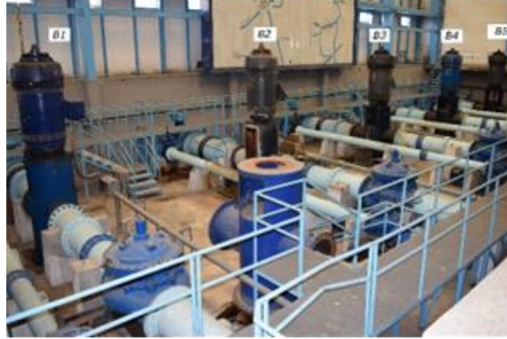
Figura 2.7. Cárcamo de succión y bombas del Rebombéo Estrella. Fuente: Domínguez-Mora et al., 2019
