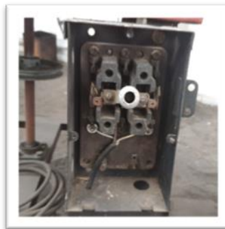
Imagen 19 Detalle del cajetín de encendido
