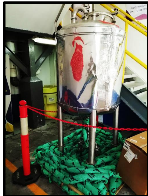
Ilustración 40 Tanque provisional delimitado con medidas de seguridad
