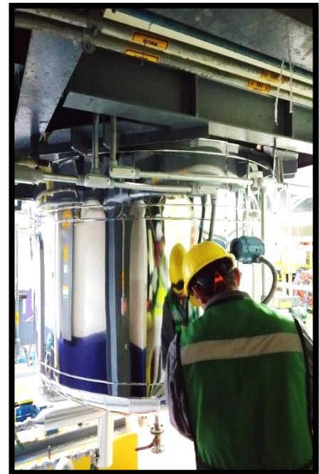
Ilustración 57 Enchaquetado de tanque.
