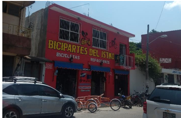
Figura 2.2 Local comercial del Istmo que presentó interrupción temporal absoluta y parcial como consecuencia del sismo de Chiapas de 2017
