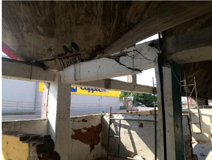
Figura 5.3 Asentamiento en el inmueble del mercado de Juchitán, el cual produjo daños en el entrepiso
