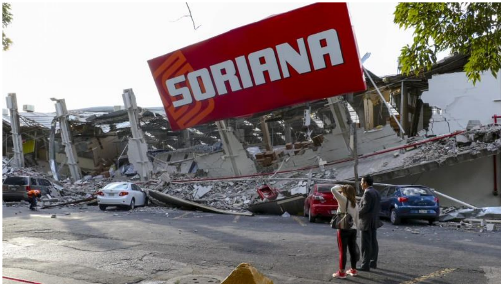
Figura 14. Colapso de la tienda Soriana Taxqueña. Fuente: Expansión. Créditos: Saúl López / Cuartoscuro
