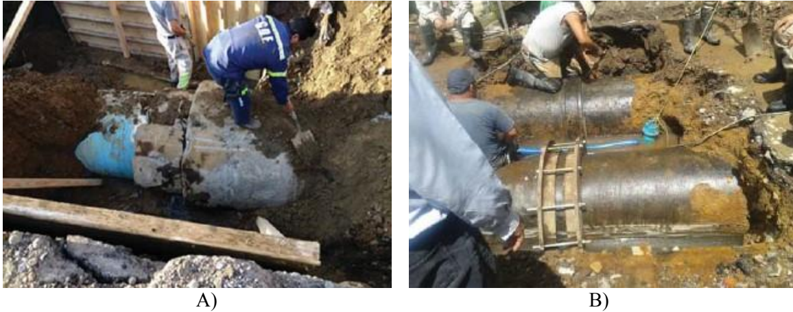
Figura 8. Fugas en red primaria de la Ciudad de México derivadas del sismo del 19S de 2017: A) Tubería de asbesto-cemento de 48 in ubicada en Tláhuac y B) Tubería de acero de 30 in situada en Xochimilco.
