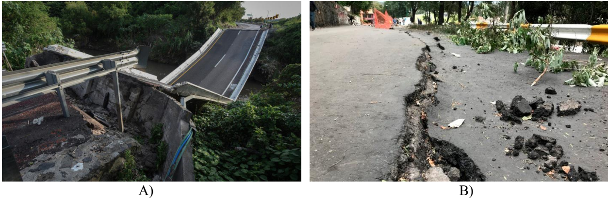
Figura 12. Daños en la infraestructura vial: A) Colapso de un puente en la autopista México-Acapulco. Fuente: El Universal. Créditos: Policía Federal y B) Agrietamiento en la carretera Xochimilco-Tulyehualco. Fuente: Quadratín México
