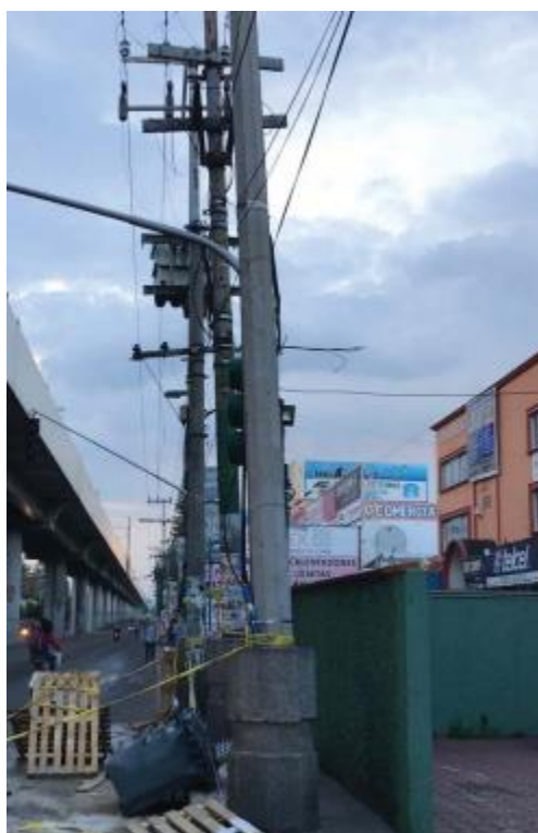
Figura 3.3 Falla de transformadores en Av. Tláhuac ocasionada por el sismo del 19S de 2017. Créditos: Miguel A. Jaimes
