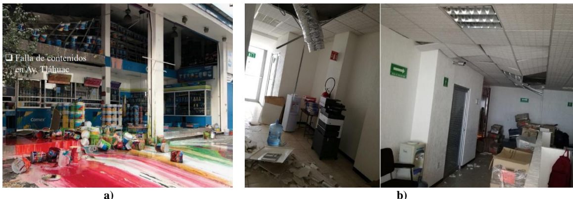
Figura 3.11 Negocios que paralizaron sus actividades como consecuencia de los daños directos no estructurales en el edificio: a) afectaciones en el stock de una Comex en Av. Tláhuac. Créditos: Miguel A. Jaimes; b) afectaciones en los plafones en oficinas de la PGR. Fuente: Sin Embargo / Créditos: Trabajadores de la PGR
