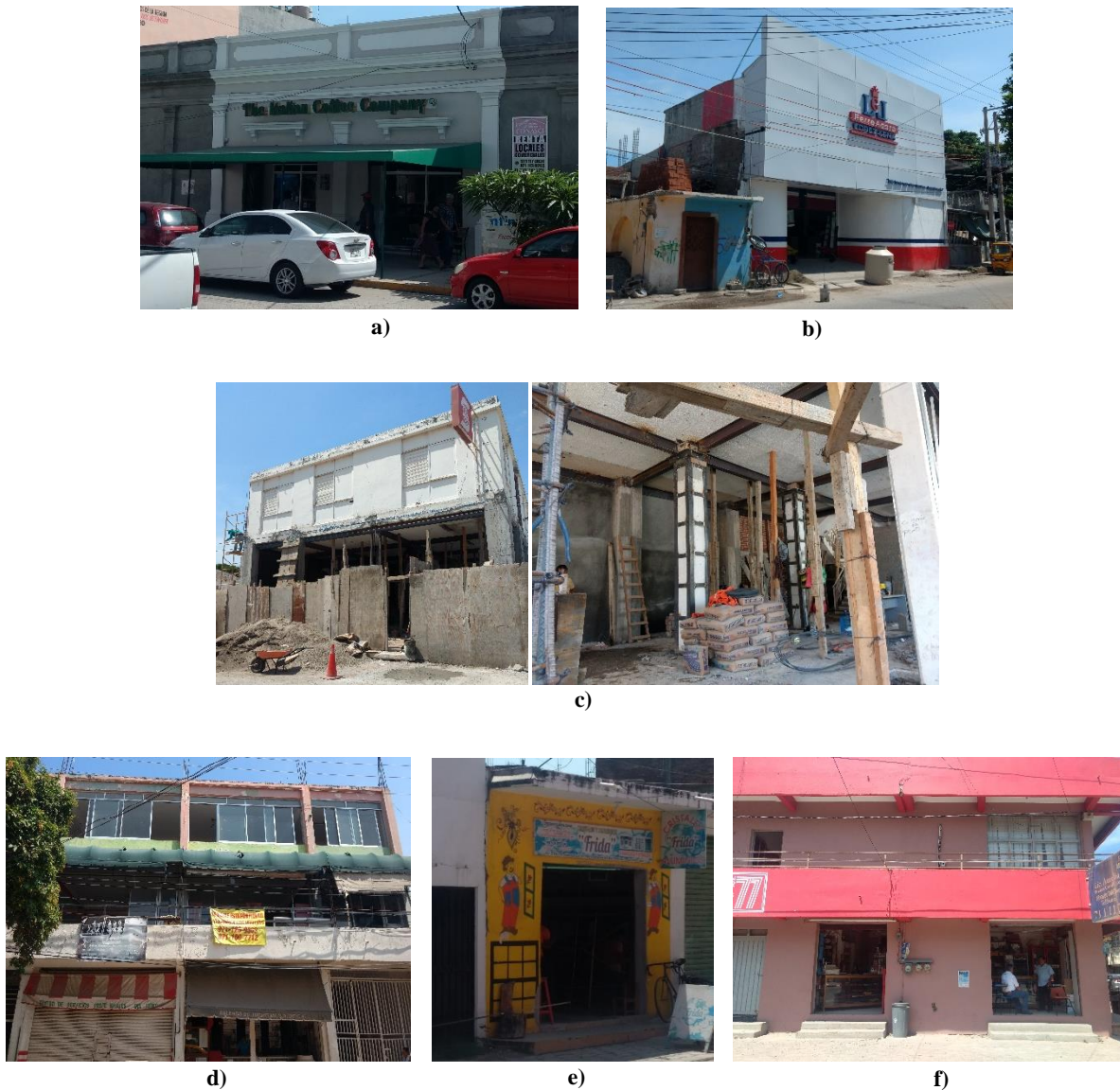
Figura 2.5 Negocios que cerraron por daños directos en sus respectivos edificios: a) cafetería; b) ferretería; c) sucursal bancaria; d) escuelas de baile y Taekwondo; e) venta de aluminios y cristales; f) papelería
