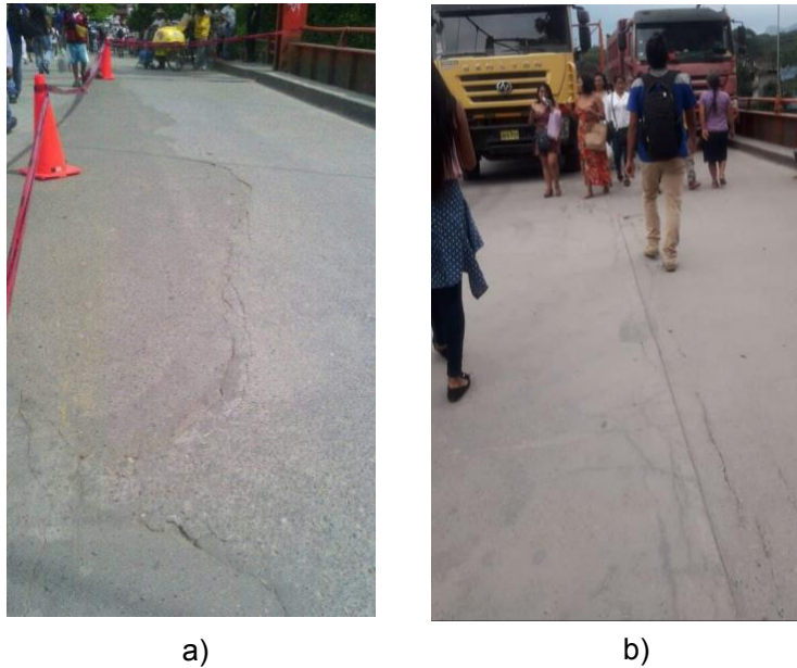
Figura 6 Daños en la superficie de rodamiento del puente Corpac; a) Desintegración leve y progresiva del concreto; b) Fisuras en el concreto. Fuente: Usuarios de redes sociales
