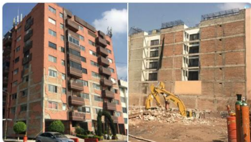
Figura 3.8 Demolición de un edificio ubicado en Paseo de los Laureles, colonia Paseos de Taxqueña, alcaldía de Coyoacán. Fuente: Milenio / Créditos: Secretaría de Obras y Servicios CDMX
