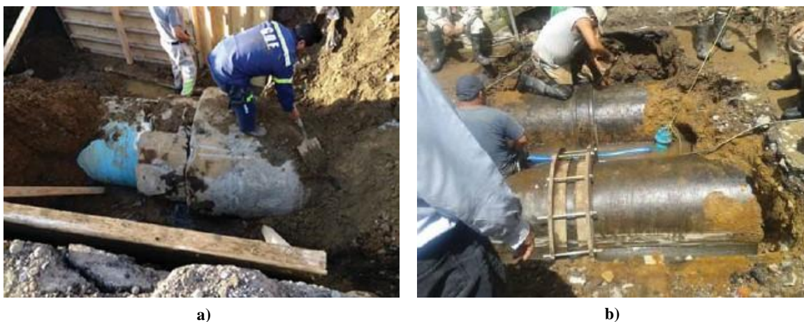
Figura 3.4 Fugas en red primaria de la Ciudad de México derivadas del sismo del 19S de 2017: a) tubería de asbesto-cemento de 48 in ubicada en Tláhuac; b) tubería de acero de 30 in situada en Xochimilco. Fuente: Ayala et al. / Créditos: SACMEX
