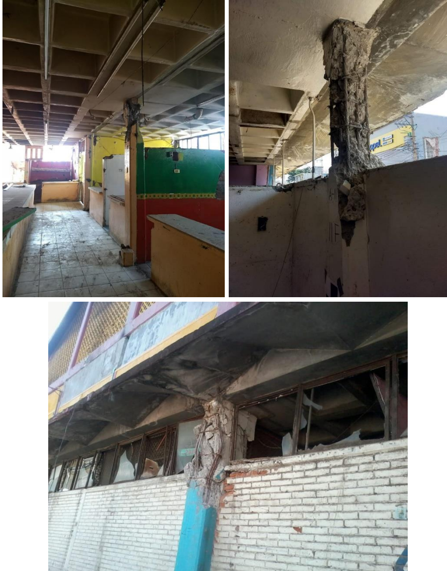
Figura 5.2 Efecto de columna corta en columnas del edificio del mercado de Juchitán
