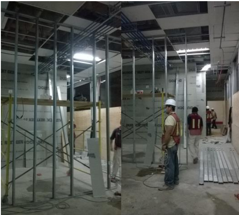
Imagen 37 y 38. Armado de bastidores para montaje de paneles de Tablaroca y Durock. Una vez terminando el colado de la plataforma de concreto se procede al trazo de muros que posteriormente serán contruidos con paneles de tablaroca y durock (en caso de zonas húmedas).
