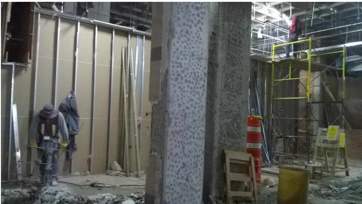
Imagen 45. Demolición de acabados en columnas y desmontaje de tubería y soporte eléctrico.
