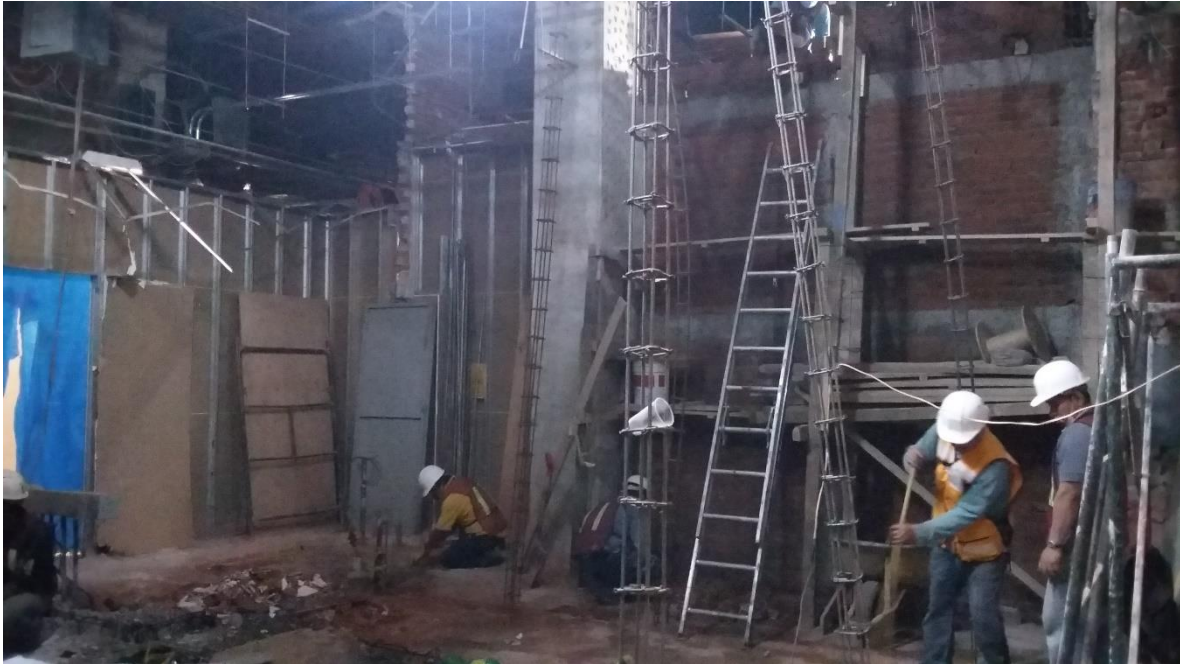
Imagen 57. Trazado de muros y ubicación de castillos para muros de tabique. Para el trazo de muros sacamos una escuadra desde un punto de referencia ubicado en la zona de elevadores. Y de ahí partimos hacia todo lo demás.
