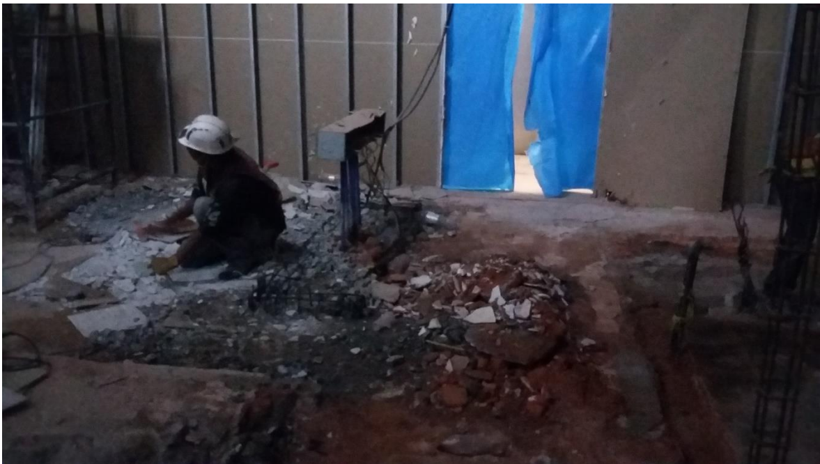
Imagen 48. Demolición manual de piso concreto, las tuberías quedan visibles y a la par son desmontadas.
