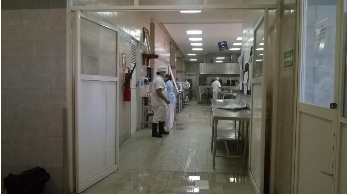
Imagen 8. Fotografía tomada en el acceso único a la cocina desde la zona de administración. Aquí podemos observar el estancamiento de agua en algunas áreas de la cocina. Los cocineros y administrativos nos confirman lo peligroso que es caminar en esta zona.
