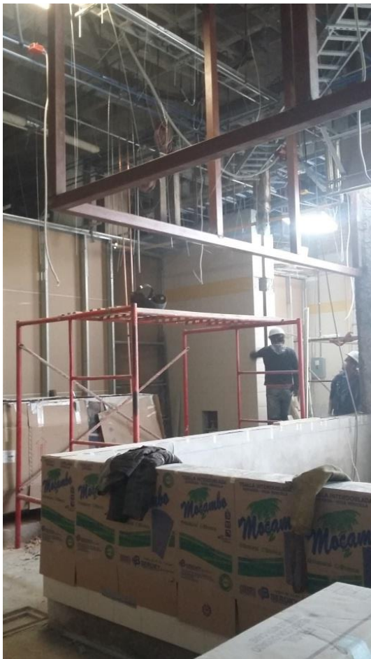
Imagen 75. Bastidor terminado. Posteriormente es pintado y sobre este se colocan paneles de tabla cemento para crear un cerramiento en la parte superior del cancel.
