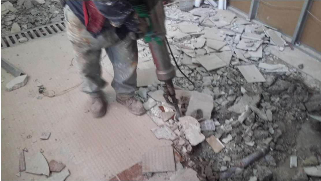
Imagen 47. Demolición de piso cerámico en cocina con ayuda de rompedores de concreto. Los trabajos en losas se realizan en un horario especial, donde el flujo de usuarios del instituto es menor, por motivos de contaminación acústica.
