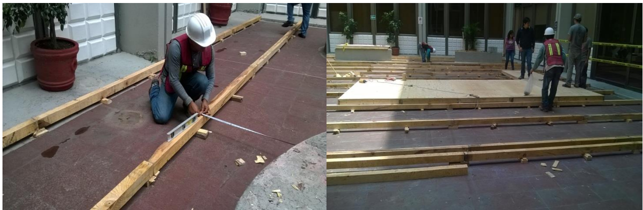
Imagen 23 y 24. Trazado y nivelación de base para comedor provisional con polines y pollos. El nivel es el mismo que el de la cocina principal para facilitar el traslado de las charolas de alimentos y al mismo tiempo para el personal discapacitado.
