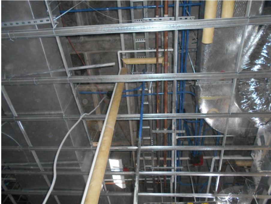
Imagen 59. Instalaciones hidráulicas y soportaría para plafones. Los tubos azules corresponden a la instalación de agua fría, la tubería beige es de agua caliente y va recubierta por un aislante térmico a base de fibra de vidrio con acabado de manta.
