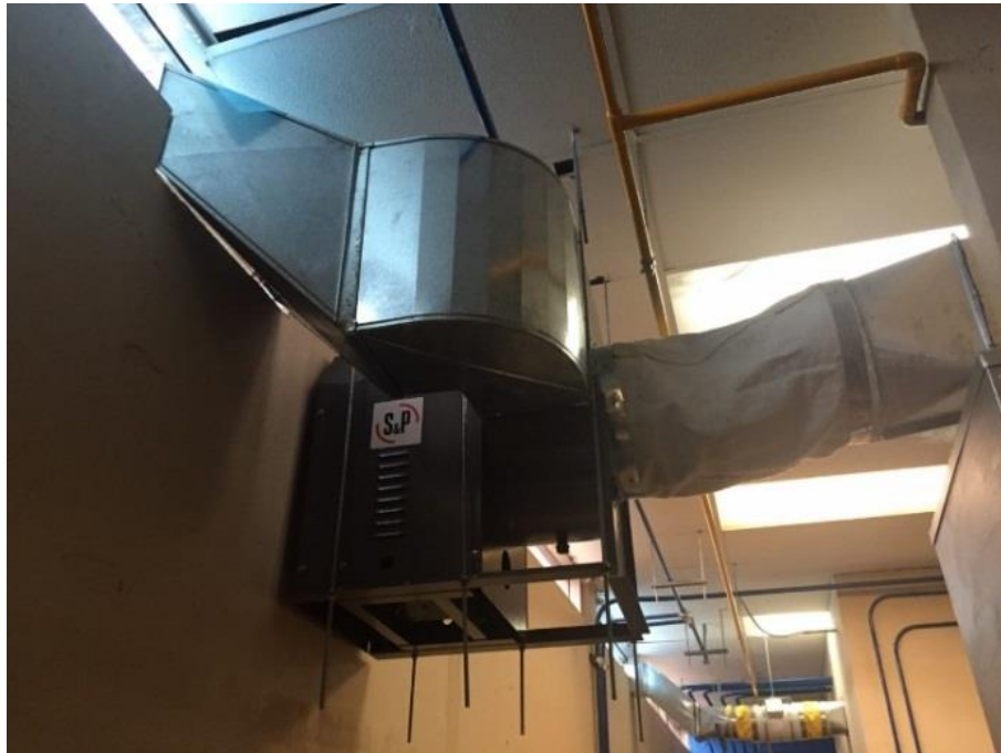
Imagen 39. Extractores de aire instalados. En la imagen podemos observar uno de los tres equipos de extracción de aire que se instalaron fijados a muro para la cocina provisional. También se observa el paso de instalaciones sobre los muros: la tubería azul corresponde a la hidráulica y la tubería amarilla a la de gas.
