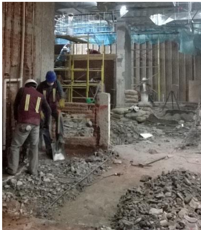
Imagen 51. Demolición manual de muros bajos de tabique empleando maceta y cincel. En caso de que el muro cuente con instalaciones, se van desmontando a la par que se hace la demolición.
