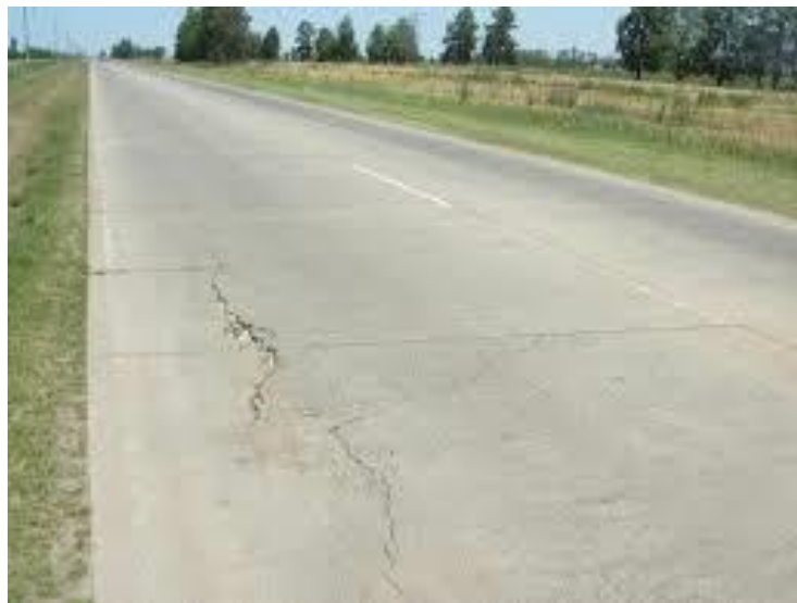
Figura 6: Grietas longitudinales o transversales en el pavimento rígido.
