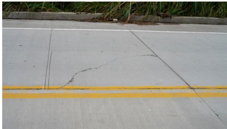
Figura 4: Agrietamiento del pavimento rígido
