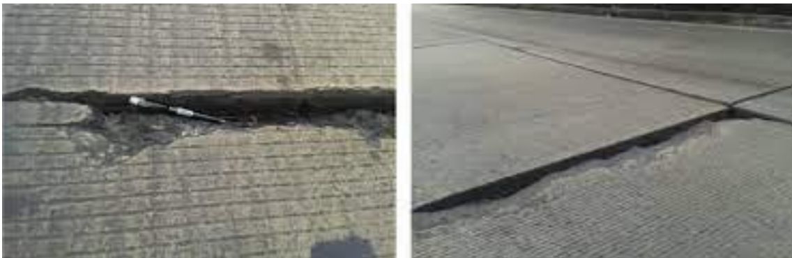
Figura 8: Despostillado de las juntas del pavimento rígido
