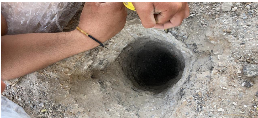
Figura 38: Excavación que se realizó para hacer el sondeo y extraer el material.
