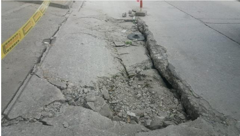
Figura 7: Falla estructural en el pavimento rígido
