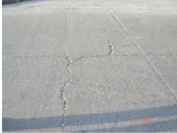
Figura 5: Grieta transversal del pavimento rígido
