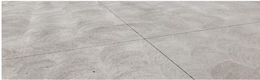
Figura 9: Pumping en el pavimento rígido
