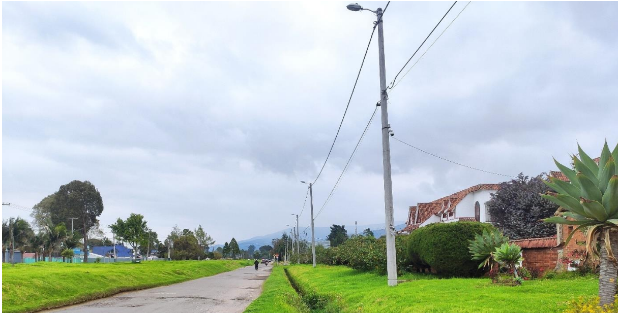
Figura 4-14 Postes de iluminación UPZ San José de Bavaria
