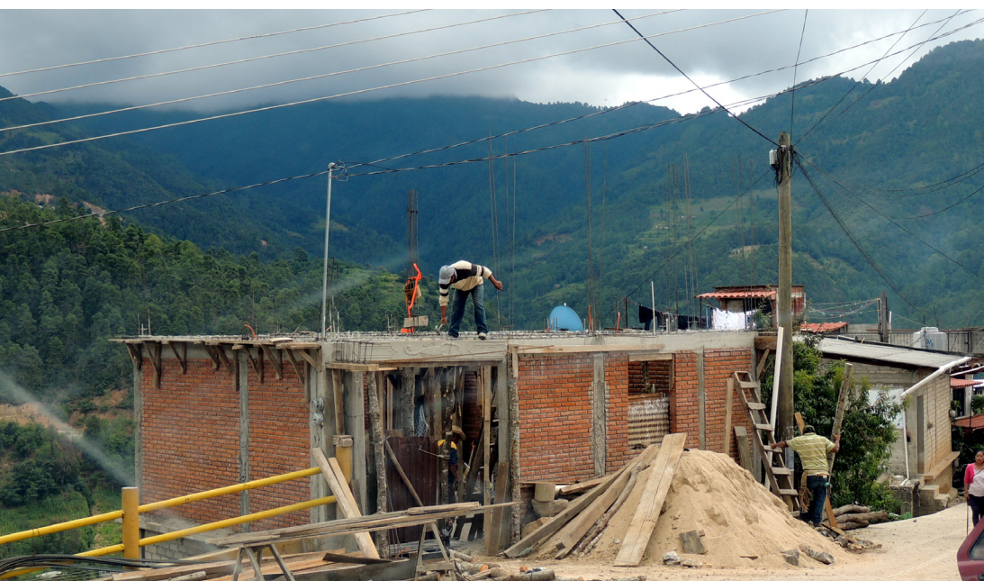
Proceso de construcción de vivienda con materiales industrializados en Tlahuitoltepec. Foto tomada por: Flor Gabriela Ríos Ventura
