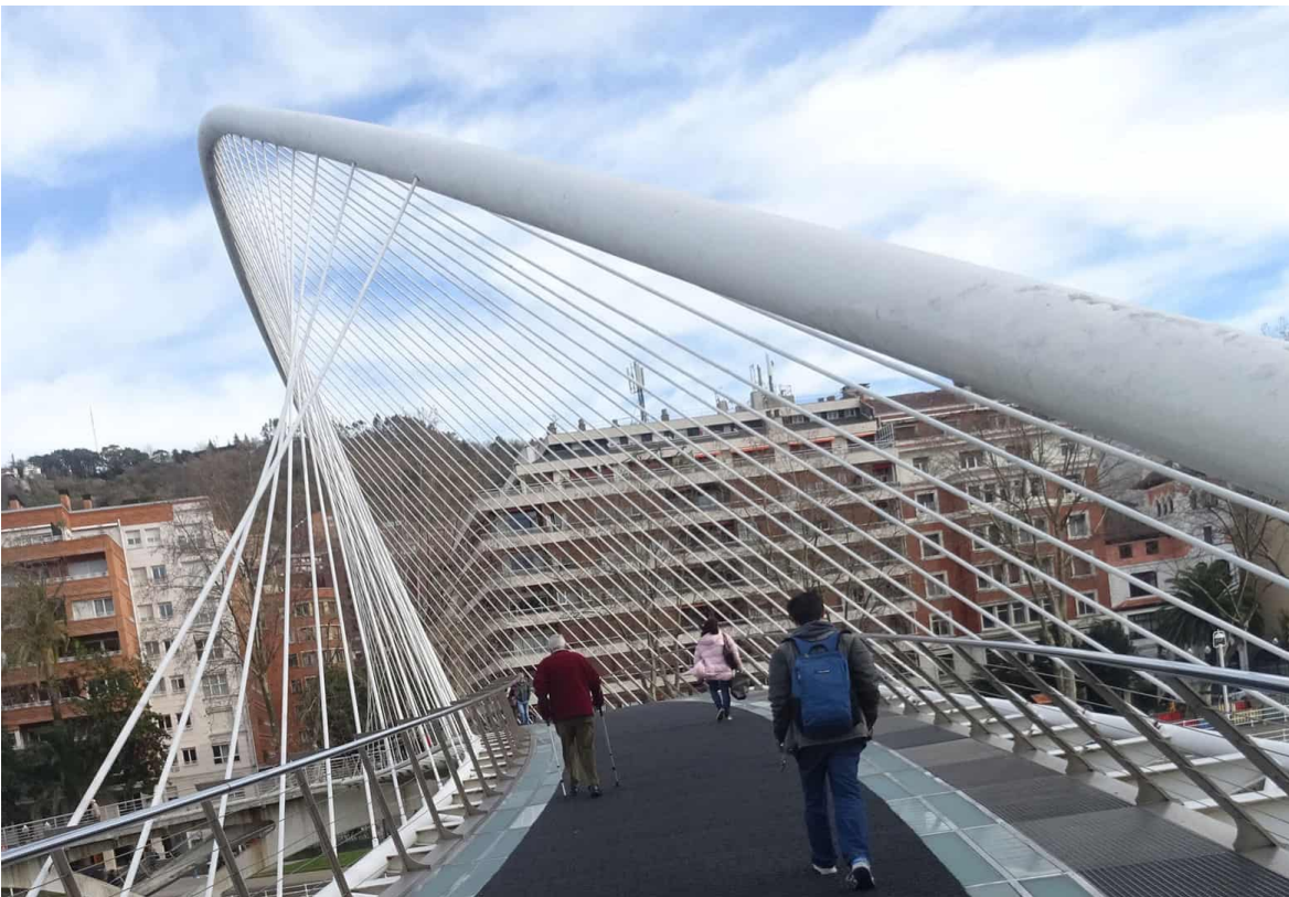
Imagen 13.0 Solución dada al puente Zubizuri, instalar un tipo de tapiz o alfombra para evitar las constantes caídas. Fotografía extraída de Fhimasa , https://fhimasa.com/solucion-fhimasa-zubizuri/
