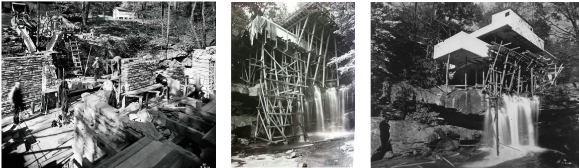
Imagen 23.0 Proceso constructivo de la Casa Kauffman; fotografía de los sistemas constructivos que utilizó el arquitecto para edificar el volado principal; el cual se flecho posteriormente al retiro de los polines de madera.
