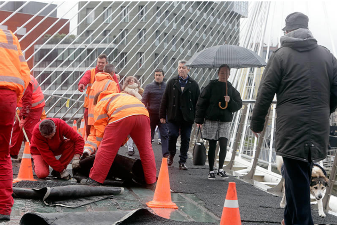
Imagen 15.0 Puente Zubizuri con ajuste del tapizado propuesto para evitar las constantes caídas provocadas por el vidrio, Fotografía de Oskar M. Bernal, extraída de https://www.deia.eus/bizkaia/bilbao/2019/01/15/usuario-zubizuri-falta-reparacion/693154.html
