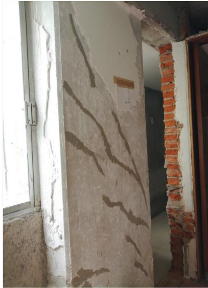
Figura 3.2.1. Columna reparada con inyección (archivo personal de Jorge Abarca, 2019)
