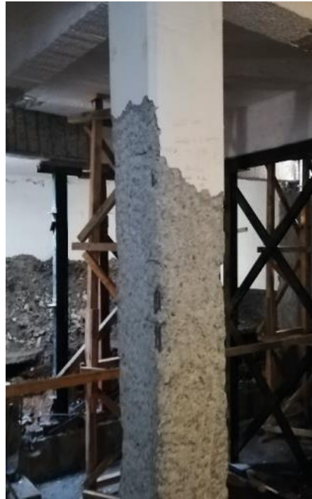
Figura 3.2.3.1 Ejemplo de incremento de rugosidad de la superficie de una columna existente
