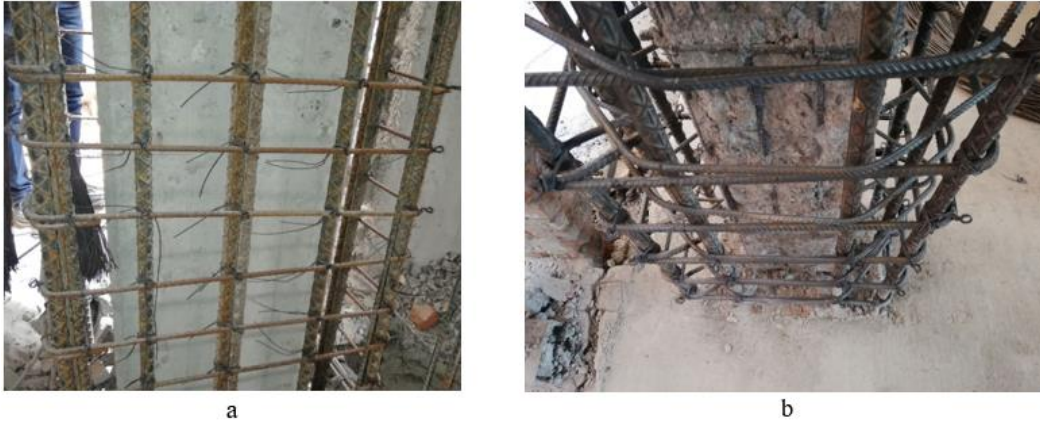
Figura 3.2.4.5 Refuerzo de encamisados de columnas: a) práctica incorrecta: estribos con dobleces a 90 grados; b) práctica correcta: estribos con dobleces a 135 grados
