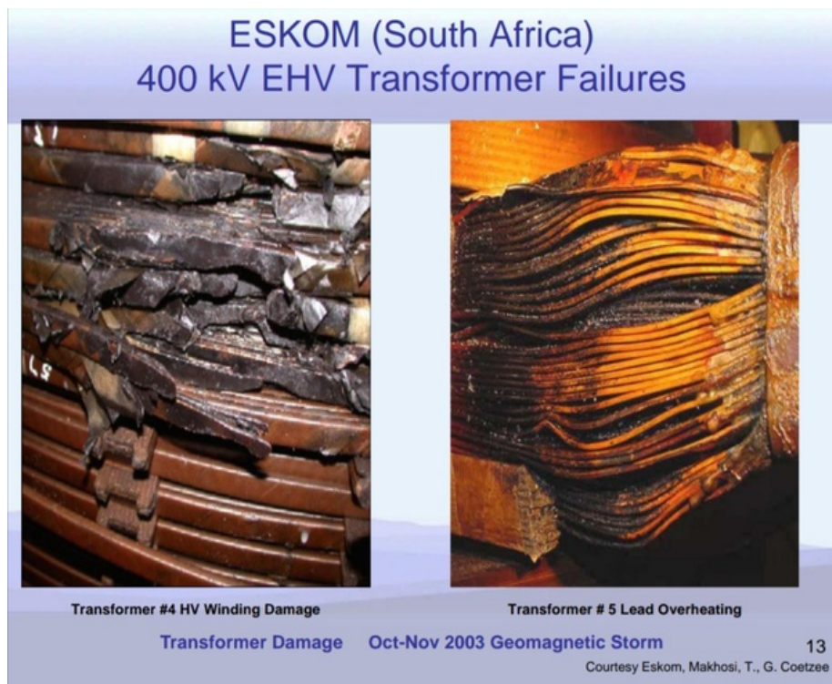
Figura 2.9: Bobinados dañados en transformadores de ESKOM en Sudáfrica. Este deterioro fue causado por CIGs no superiores a 10 A fluyendo por algunas horas durante las Tormentas de Halloween, Octubre - Noviembre 2003 (Gaunt and Coetzee, 2007)
