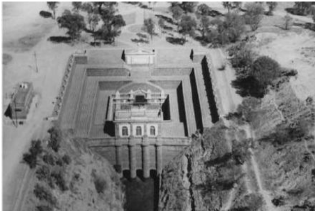
Figura 4.4. Vista general de la caja colectora del túnel de Tequisquiac, hacia aguas abajo. Estado de México. Archivo histórico del agua 1973. (Aguilar. et.al , 2011)
