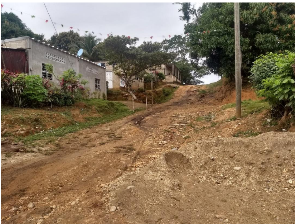
Figura 13. Camino en mal estado
