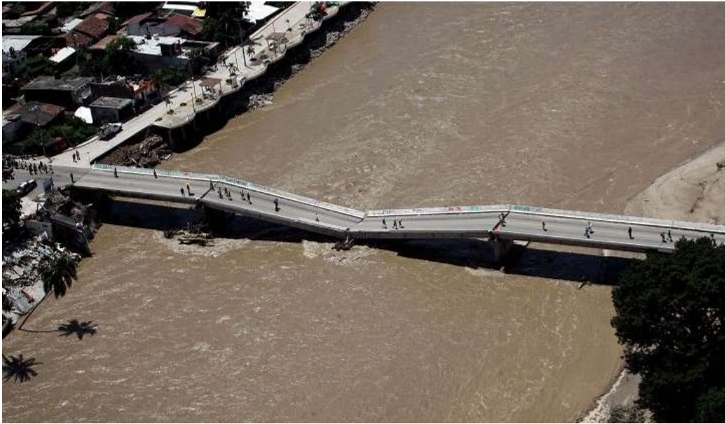
Figura 26. Colapso del puente de Coyuca de Benítez tras el paso del huracán Manuel (2013) (CENAPRED)
