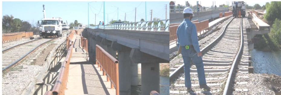
Figura 21. Daño por sismo en vía de ferrocarril en la vecindad de Mexicali Sismo de Mexicali de 2010 Fuente: CENAPRED
