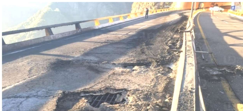
Figura 28. Daños en carpeta y losa puente El Carrizo
