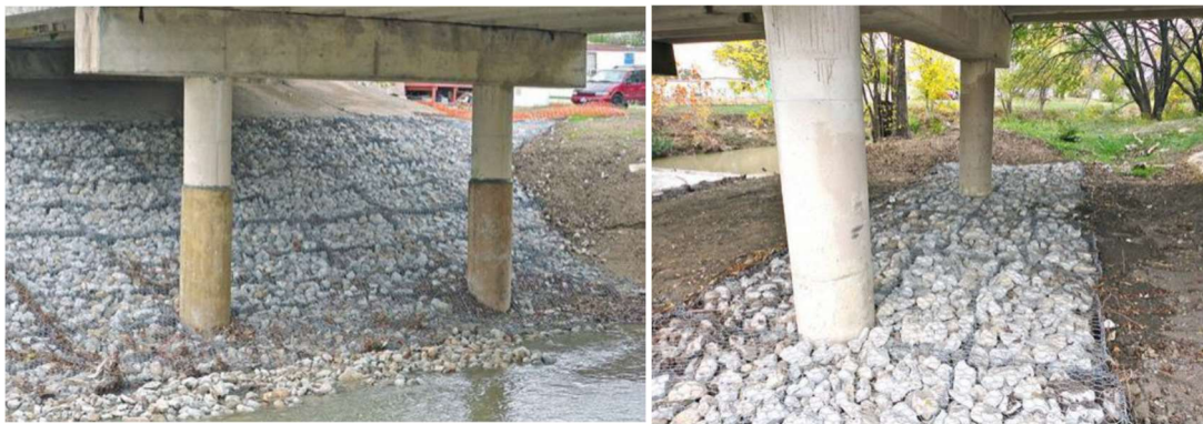
Protección de pilas y estribos con sacos rellenos
