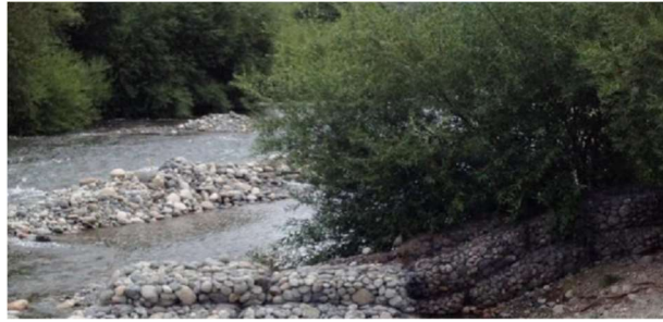
Protección con sistemas de puntos fijos
