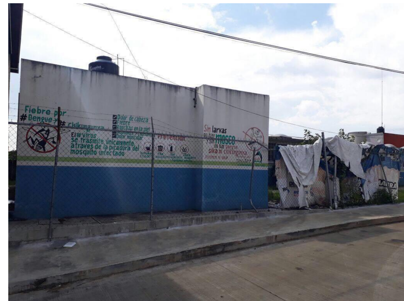
Toma 4: fachada de la calle secundaria la cual esta en muy mal estado y la gente lo utiliza para dejar basura
