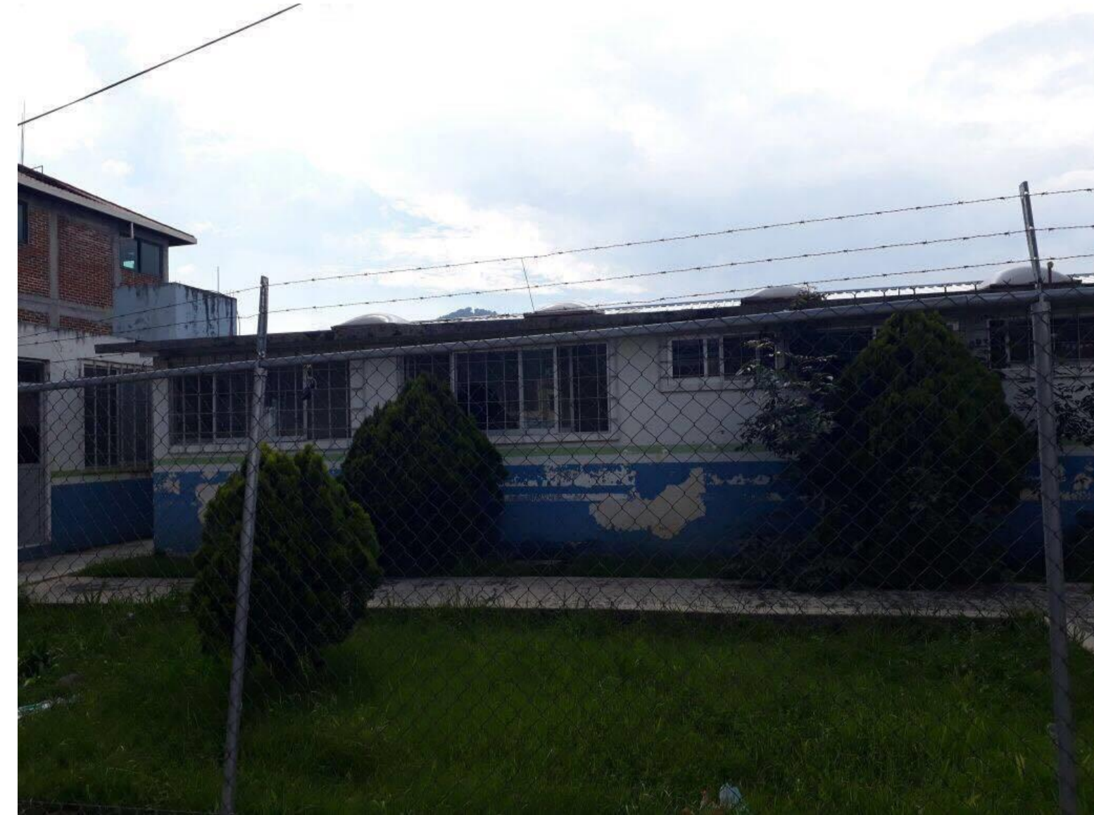
Toma 6: se aprecian las paredes despintadas y con humedad. Ya no se le da mantenimiento al edificio
