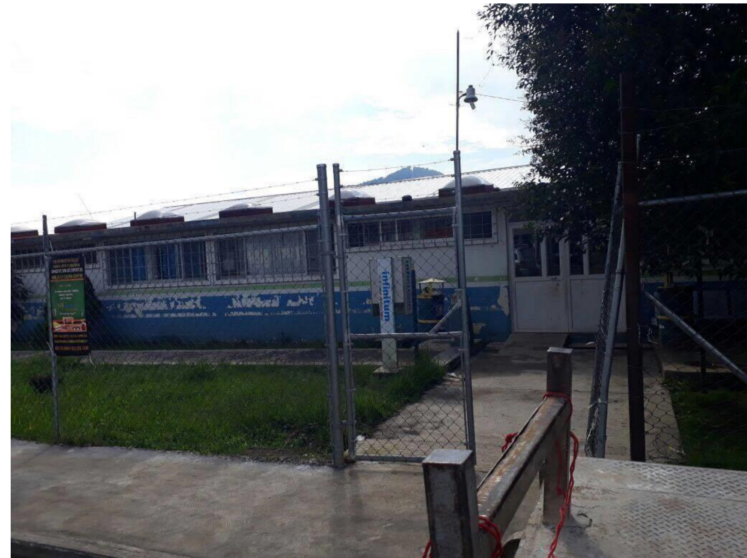
Toma 2: acceso principal del centro de salud el cual se puede apreciar en mal estado
